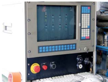
c) Centrale de pilotage. Noter le bouton rouge d'arrêt d'urgence en bas à gauche. Crédit photo M. P. DANTEC -LRPC de Clermont Ferrand
