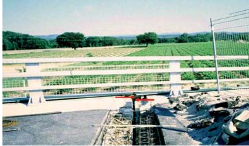
Figure 10 : Conséquence d'un oubli de libération des manchons des lisses d'une barrière de sécurité (l'effort de soulèvement aurait aussi été majoré de 80 t !). Crédit photo D. ESB RAT
