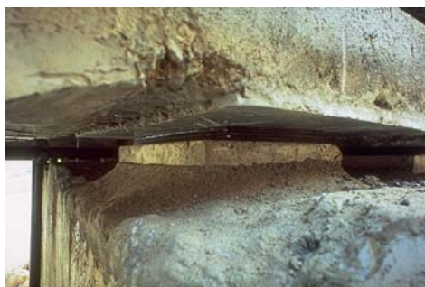
Figure 47 : Réalisation d'un bossage inférieur par plaque en béton préfabriqué sur mortier de résine. Crédit photo SETRA/CTOA
