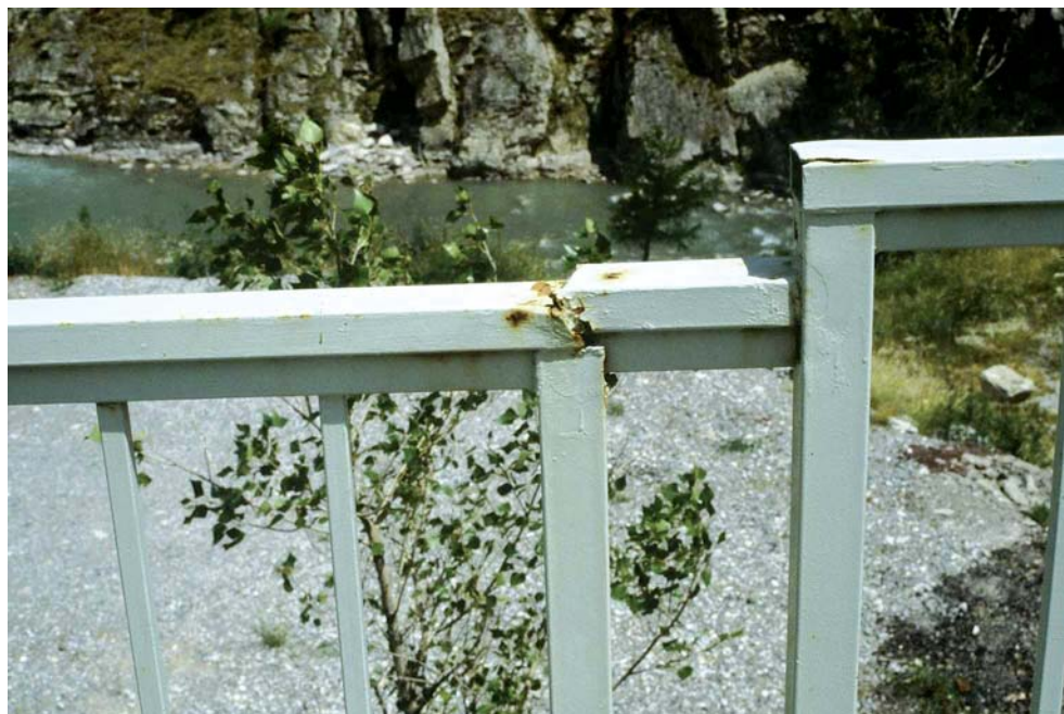
Figure 53 : Ne pas oublier de recalibrer les équipements, comme ce garde-corps, si la structure est reposée à un niveau différent.
