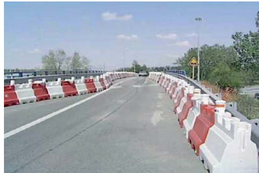
Figure 54 : Balisage de sécurité visant à bien positionner la voie laissée en circulation. A noter l'utilisation de SMV (Séparateur Modulaire de Voie) légers pour ne pas augmenter la charge à soulever. Crédit photo D. ESBRAT
