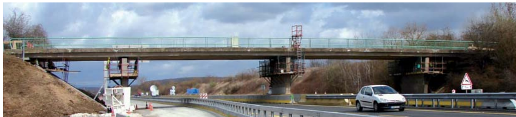
Figure 28 : Vue générale d'un chantier de vérinage sur un PS d'autoroute avec les dispositifs de sécurité pour la circulation sous l'ouvrage, les accès aux plateformes de travail fixées par consoles sur l'appui, etc. Crédit photo D. WEISSE - TSV
