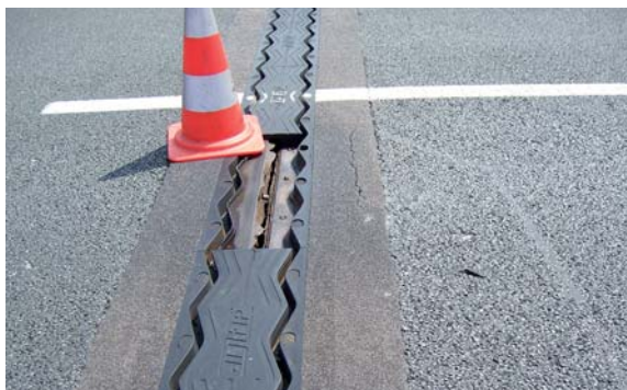
Figure 8 : mise en sécurité dans l'attente d'une réparation définitive ou d'une réfection complète du garde-corps. Crédit photo M. Fragnet
