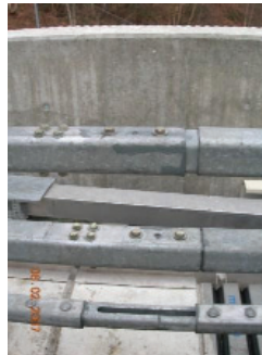
Figure 12 : exemple de défaut de fonctionnement d'un dispositif de dilatation : les deux lisses supérieures n'ont pas la même ouverture que la lisse inférieure. Crédit photo EGIS Route
