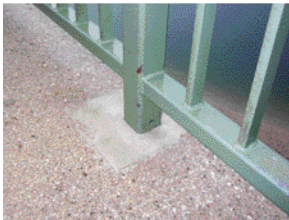
Figure 16 : trou de drainage dans la partie inférieure d'un profilé creux. Crédit photo M .Fragnet
