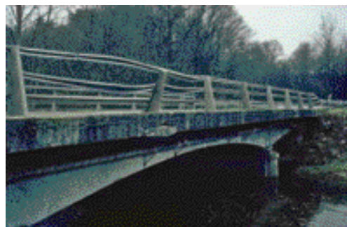
Figure 18-2 : rupture du hourdis de cet ouvrage faute d'avoir mis en place les ancrages fusibles de la BN4 lors d'une réparation. Crédit photo SETRA/CTOA
