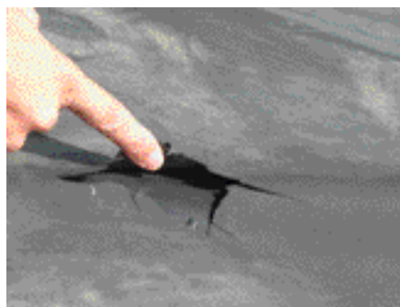
a) Déchirure par vieillissement du matériau
