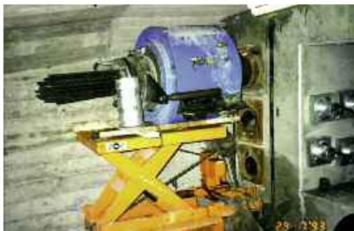
Photo n° 129 : dispositif de levage et de manutention d'un vérin pendant les réparations du pont de Blagnac (crédit photo D. Poineau)
