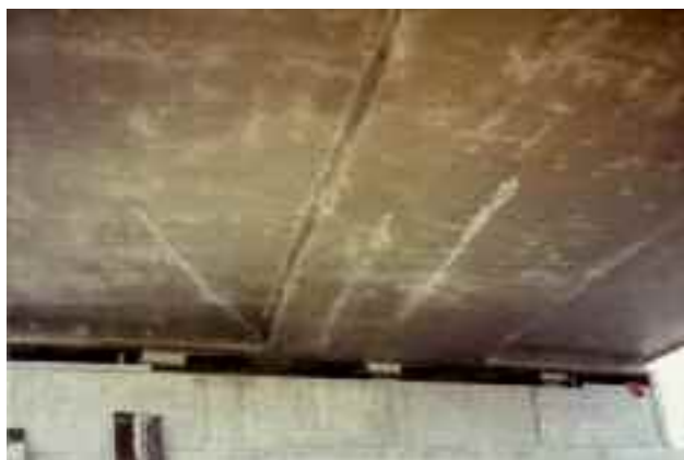
Photo n° 10 : exemple de fissure de diffusion sur un des abouts d'un pont-dalle en BHP et pourtant de classe B 80 (crédit photo D. Poineau)
