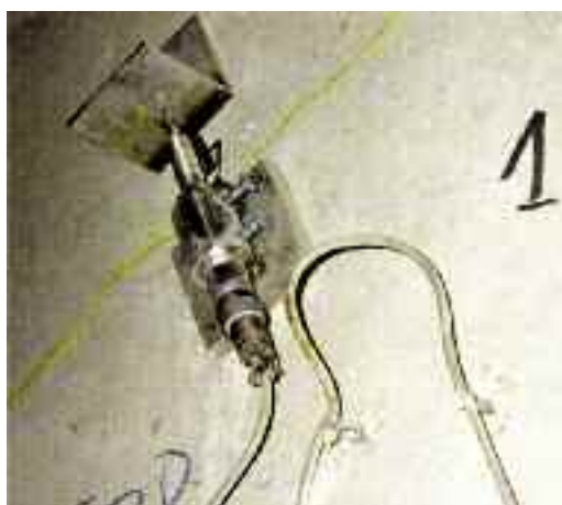
Photo n° 151 : capteur de déplacement placé à cheval sur une fissure (crédit photo D. Poineau)
