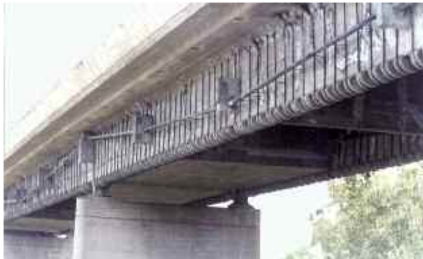
Photo n° 50 : alliance de la précontrainte longitudinale et des étriers actifs (crédit photo Freyssinet)
