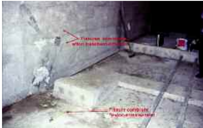
Photo n° 9 : fissures combinées d'effort tranchant et de diffusion dans une poutre-caisson précontrainte (crédit photo D. Poineau)
