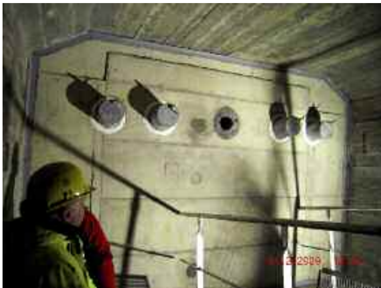
Photo n° 136 : capots de protection en place au viaduc de Verberie (crédit photo D. Poineau)
