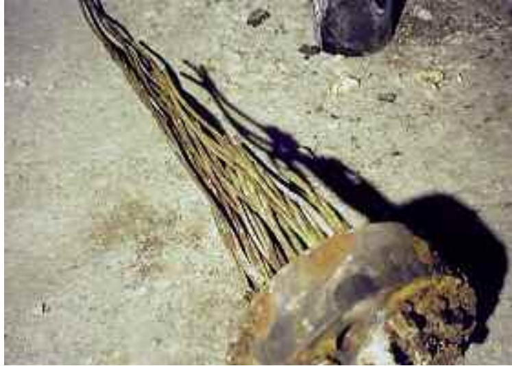
Photo n° 138 : câble rompu par corrosion au viaduc de Val Durance (crédit photo D. Poineau)
