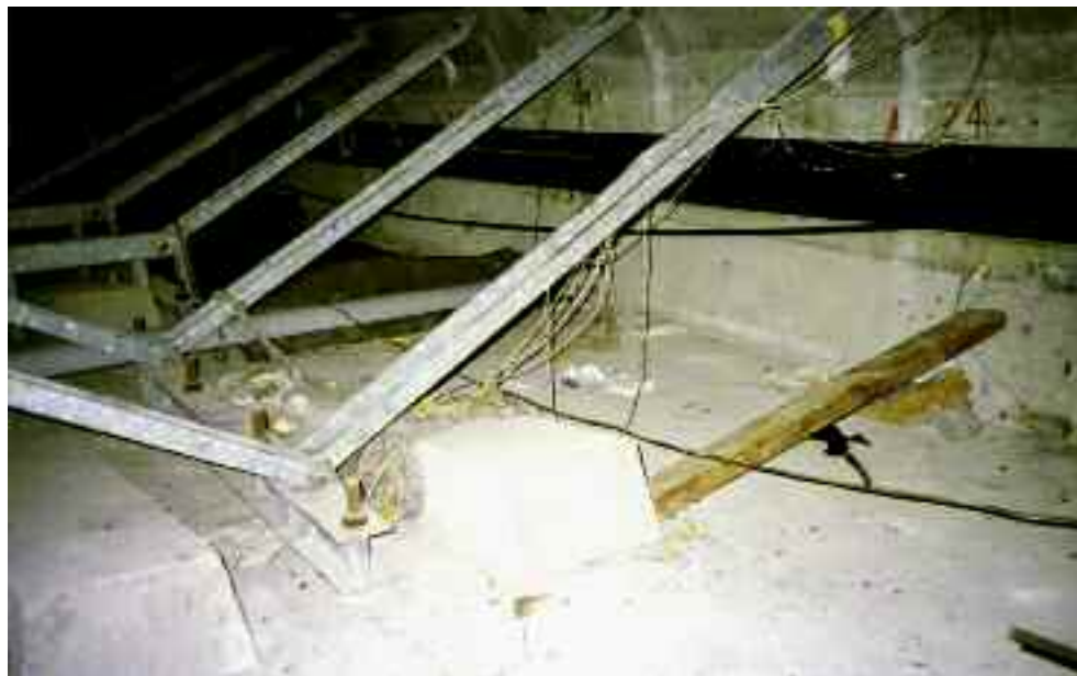
Photo n° 57 : dispositif de suspension du hourdis inférieur au pont de Corbeil (crédit photo D. Poineau)
