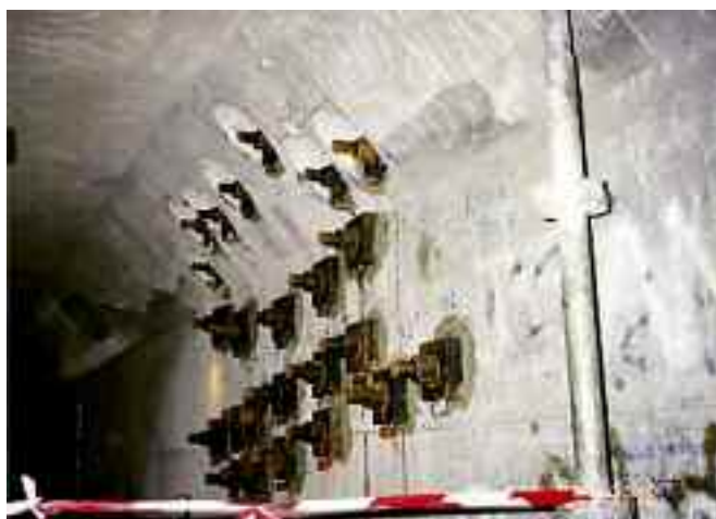
Photo n° 95 : barres de serrage du massif d'ancrage vue de l'extérieur du tablier (crédit photo Sétra)
