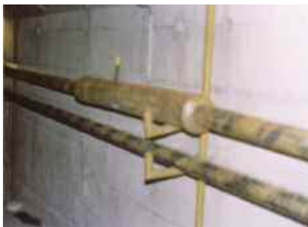
Photo n° 113 : supports des conduits métalliques et vase d'expansion pour une injection à la graisse (crédit photo LRPC)
