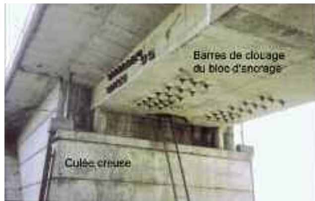
Photo n° 36 : vue des barres de fixation sur les âmes et le hourdis inférieur du massif d'ancrage du pont de Layrac (crédit photo D. Poineau)
