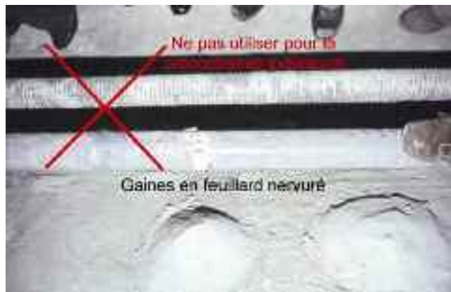
Photo n° 65 : gaine classique en feuillard nervuré (crédit photo D. Poineau)
