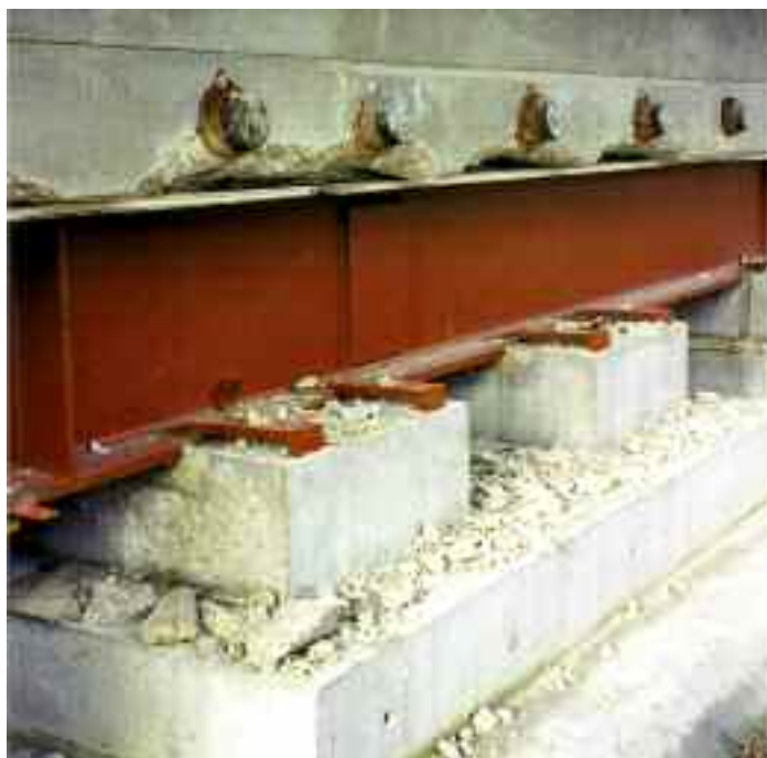
Photo n° 53 : exemple d'éclatements du béton sous des ancrages (crédit photo D. Poineau)
