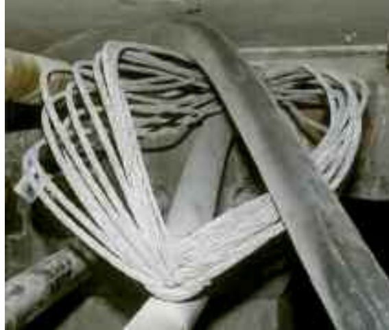
Photo n° 141 : enchevêtrement des câbles sectionnés au viaduc de Val Durance (crédit photo D. Poineau)
