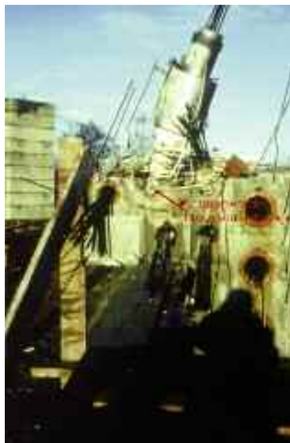
Photo n° 11 : écrasement du béton sous un ancrage lors de la mise en tension d'un câble de précontrainte (crédit photo D. Poineau)
