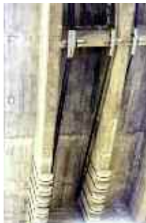
Photo n° 103 : déviateurs proches du type b 3 (crédit photo Freyssinet)
