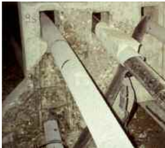
Photo n° 143 : désordres sur un déviateur causés par les organes de déviation de type b3 (crédit photo D. Poineau)
