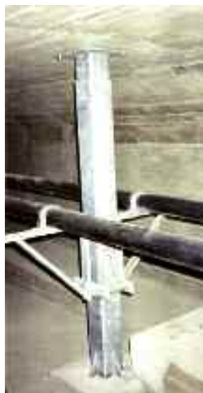
Photo n° 40 : dispositif antivibratoire au pont de Labéraudie (crédit photo D. Poinéau)
