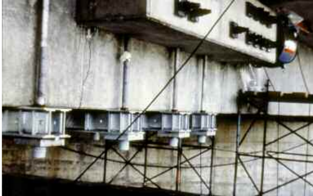
Photo n° 34 : bossage d'ancrage au pont de Lestelle et étriers de renforcement de l'âme d'un tablier à deux nervures (crédit photo LRPC de Toulouse)
