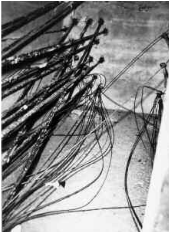
Photo n° 22 : état de la précontrainte extérieure du pont de Can-Bia (crédit photo D. Poineau)
