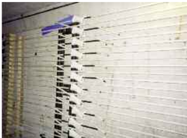
Photo n° 29 : ancrages non fixés sur la structure sur un pont de l'autoroute A4 (crédit photo D. Poineau)
