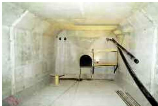
Photo n° 44 : déviateur au droit d'une entretoise sur pile au pont de Châlons-en-Champagne (crédit photo Sétra)
