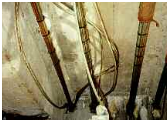
Photo n° 61 : conséquences de la corrosion des câbles galvanisés du pont de Vaux-sur-Seine ; sur la photo sont visibles les gaines en feuilard non étanches (crédit photo D. Poinéau)
