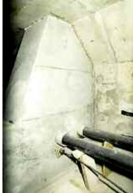
Photo n° 43 : déviateur intermédiaire au pont de Châlons-en-Champagne (crédit photo D. Poineau)
