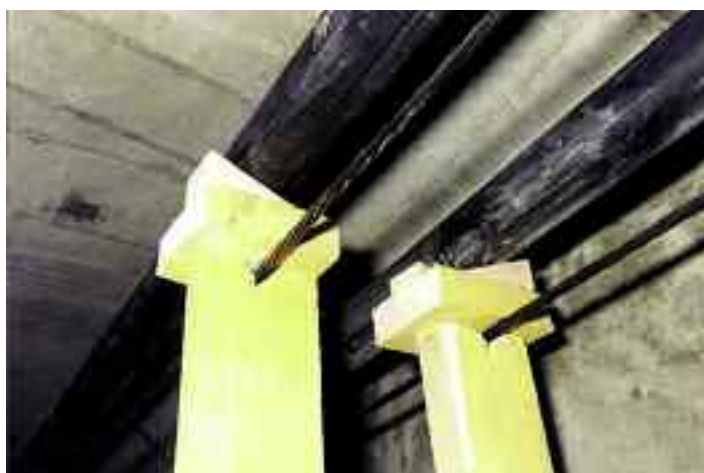
Photo n° 114 : support de gaines en PEHD (crédit photo Séttra)
