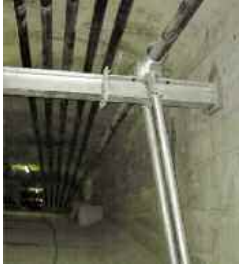
Photo n° 101 : déviateur entièrement métallique au pont de Bellevue (crédit photo Jean-Luc Martin DDE 44)
