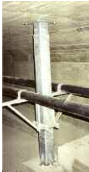
Photo n° 134 : dispositif antivibratoire au pont de Labéraudie (crédit photo D. Poineau)
