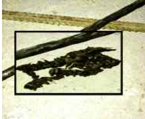
Photo n° 120 : monotoron gainé-protégé quasiment «épluché» lors de sa mise en place (crédit photo D. Poineau)
