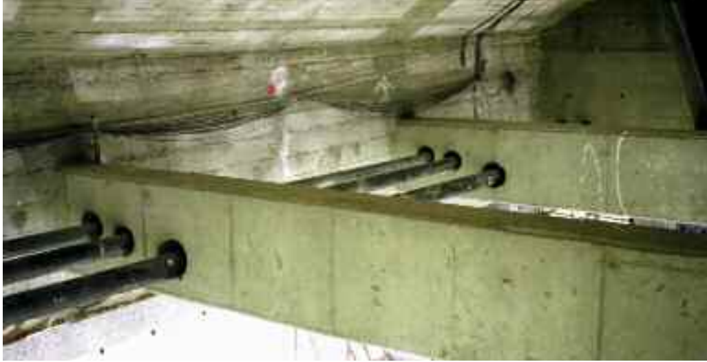
Photo n° 56 : nervures transversales ajoutées pour redonner l'inertie de torsion du tablier du pont de Blagnac (crédit photo D. Poineau)
