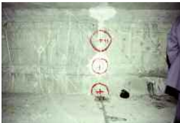
Photo n° 5 : fissures de flexion au pont du Bouc au niveau et à proximité d'une reprise de bétonnage (Photo D. Poineau)
