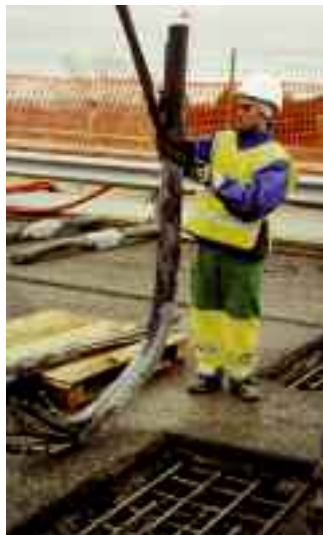
Photo n° 140 : extraction d'un tronçon de câble au viaduc de Val Durance (crédit photo D. Poineau)
