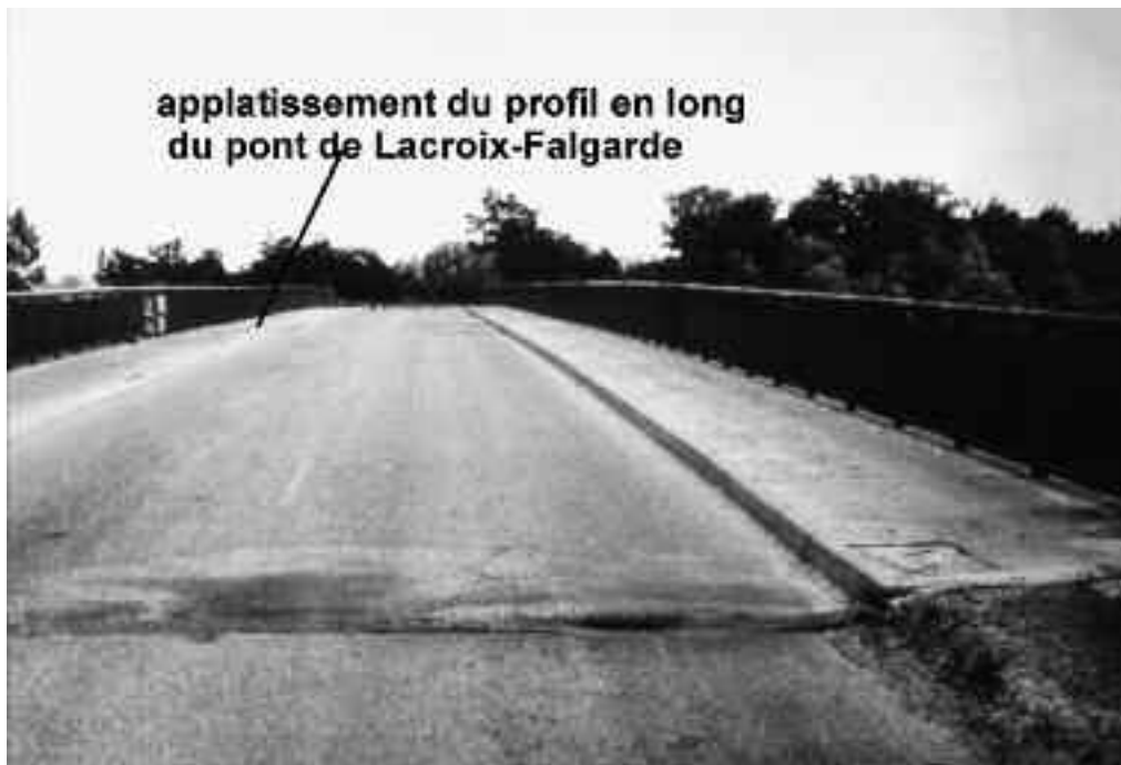
Photo n° 4 : déformation du profil en long d'un tablier en béton précontraint (Crédit photo LRPC Toulouse)
