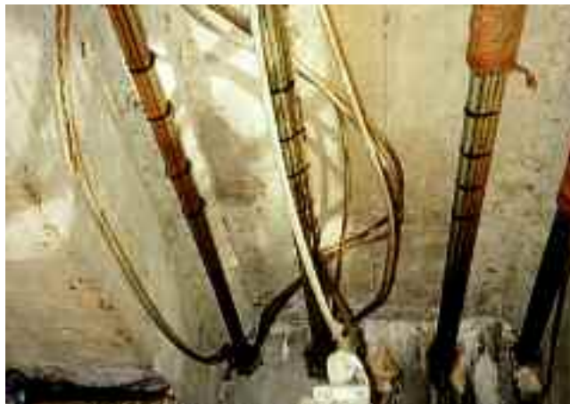
Photo n° 137 : câbles galvanisés rompus par corrosion au pont de Vaux-sur-Seine - Les liens réduisent les risques de fouettement (crédit photo D. Poineau)
