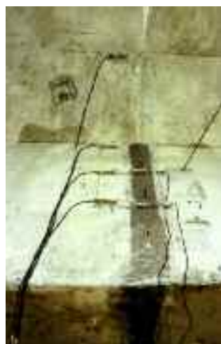
Photo n° 127 : fissures prêtes à être injectées et jauges et capteurs opérationnels (crédit photo LRPC)
