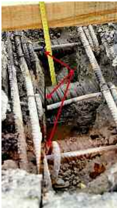
Photo n° 86 : câbles sectionnés lors d'une opération de sciage mal organisée (crédit photo D. Poinéau)
