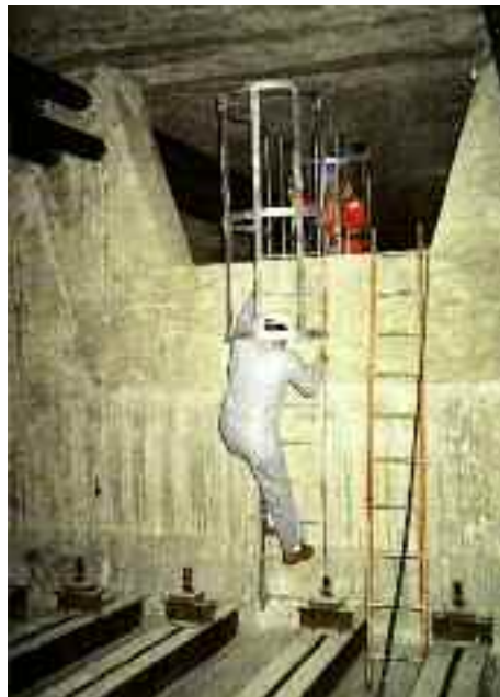
Photo n° 130 : obstacle difficile à franchir pour le matériel même si l'accès est sécurisé pour le personnel (crédit photo D. Poineau)
