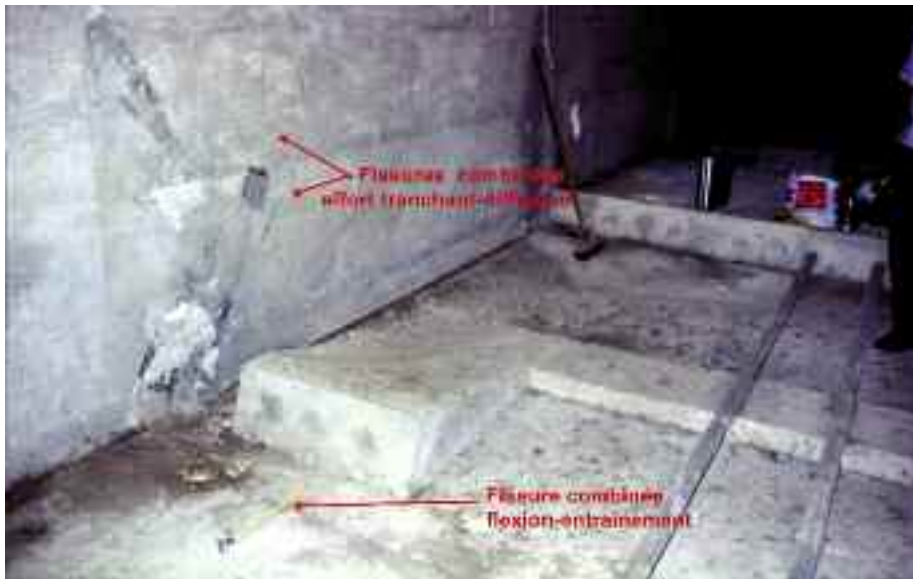
Photo n° 6 : fissures dues à la combinaison de la flexion et de l'effort tranchant avec les efforts d'entraînement et de diffusion dans une poutre-caisson précontrainte (crédit photo D. Poineau)
