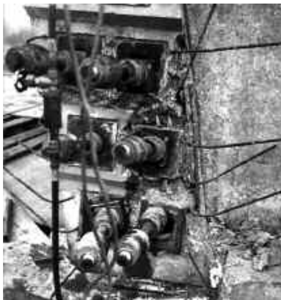
Photo n° 51 : écrasement du béton sous les ancrages lors de la mise en tension des armatures de précontrainte lors de la construction d'un pont près de Toul (crédit photo D. Poinéau)
