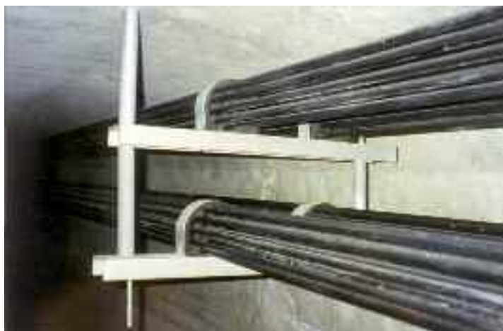
Photo n° 123 : dispositif de liaison qui sert également de dispositif antivibratoire (crédit photo D. Poinéau)
