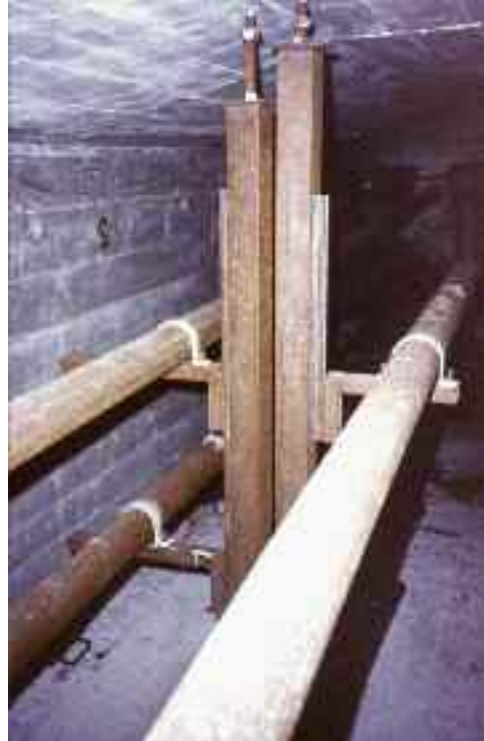
Photo n° 23 : état de corrosion des conduits métalliques non protégés de la précontrainte du pont de Layrac (crédit photo D. Poineau)
