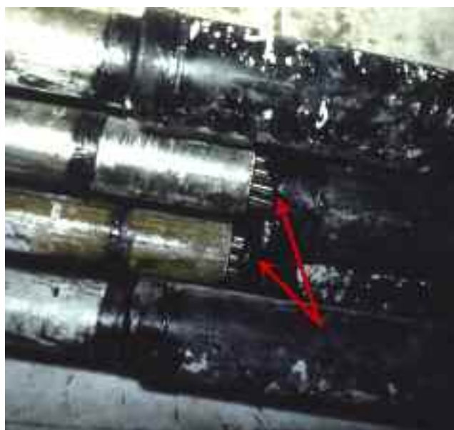
Photo n° 70 : manchons thermo-rétractables rompus au pont sur l'Arve II (crédit photo LRPC)
