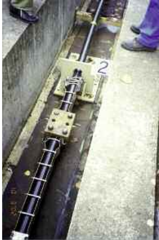
Photo n° 139 : premiers essais d'un dispositif d'absorption d'énergie au LCPC de Nantes (crédit photo D. Poineau)
