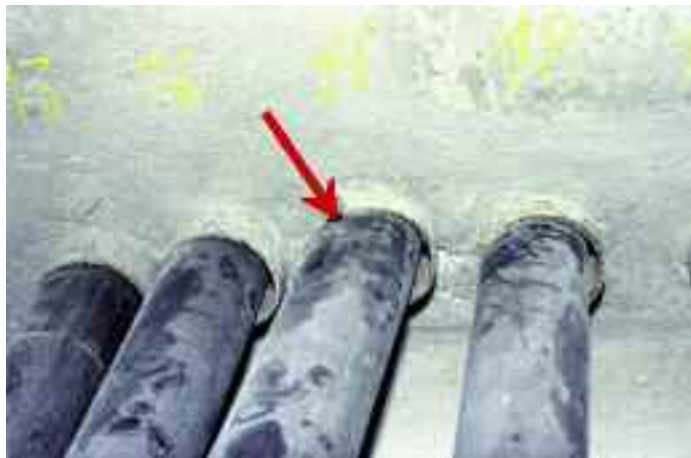
Photo n° 73 : exemple de pincement d'un tube en polyéthylène au pont de Moulins-Lès-Metz (crédit photo D. Poineau)
