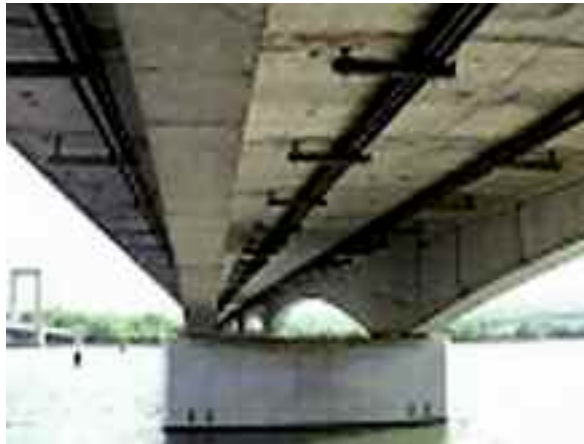
Photo n° 24 : pont autoroutier de Roquemaure réparé par une précontrainte additionnelle au tracé rectiligne (crédit photo Jacques Mossot)
