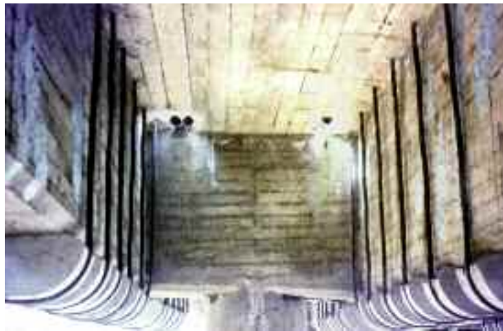
Photo n° 104 : étriers actifs extérieurs au béton de l'âme des poutres sous forme de monotorons gainés-protégés (crédit photo Freyssinet)
