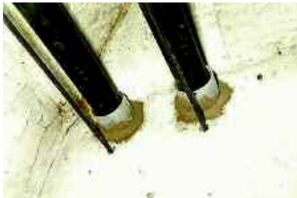
Photo n° 102 : organes de déviation scellés au droit d'une entretoise sur pile (crédit photo Sétra)
