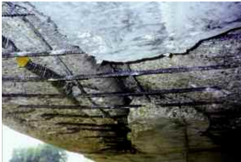
Photo n° 15 : poussée au vide locale due à un déplacement des câbles au bétonnage (crédit photo D. Poineau)
