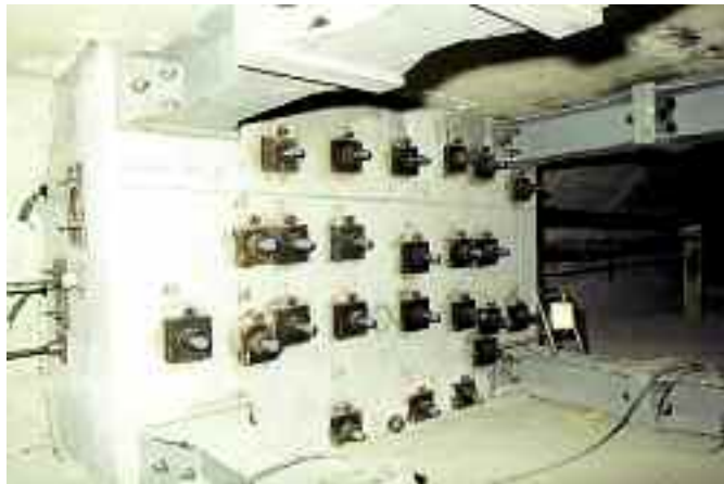
Photo n° 35 : massif d'ancrage et ses tirants-butons à proximité de l'about au pont de Châlons-en-Champagne (crédit photo Séttra)
