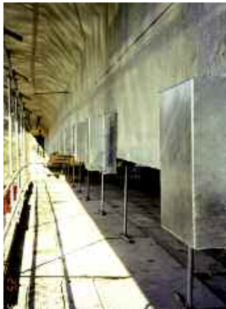
Photo n° 21 : capots masquant les blocs d'ancrage de la précontrainte transversale additionnelle du hourdis inférieur pour des raisons d'aspect et de protection (crédit photo Sétra)
