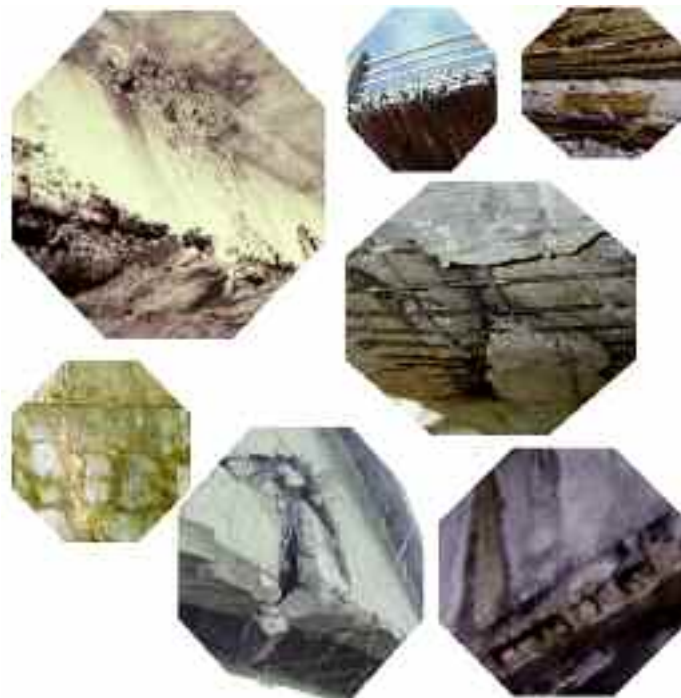
Photo n° 2 : différents désordres de structures en béton armé et précontraint (photomontage)
