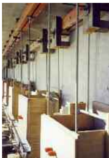
Photo n° 30 : coffrages de réalisation des bossages d'ancrage de groupe monotorons fixés sur la structure au pont d'Agde (crédit photo D. Poineau)
