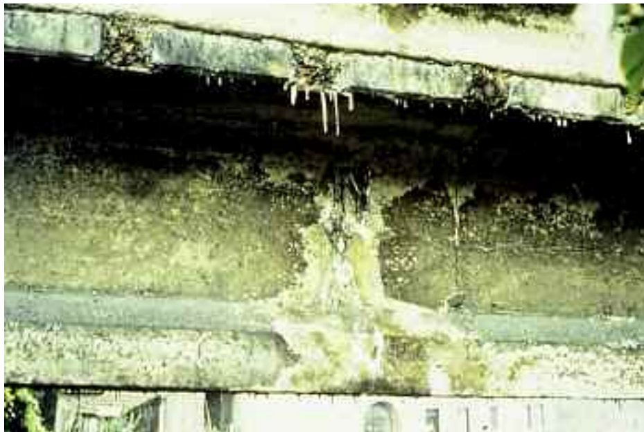
Photo n° 3 : état d'un pont non entretenu de l'est de la France (crédit photo LRPC Nancy)
