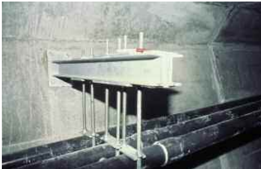
Photo n° 41 : dispositif antivibratoire au pont du Maréchal Juin (crédit photo LRPC de Lyon)
