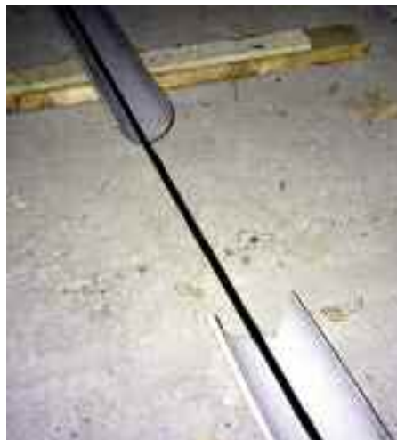
Photo n° 119 : gouttière pour empêcher le frottement sur le béton d'un monotoron gainé protégé (crédit photo D. Poineau)
