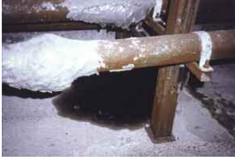
Photo n° 66 : ressuage de graisse et corrosion des tubes (crédit photo D. Poineau)
