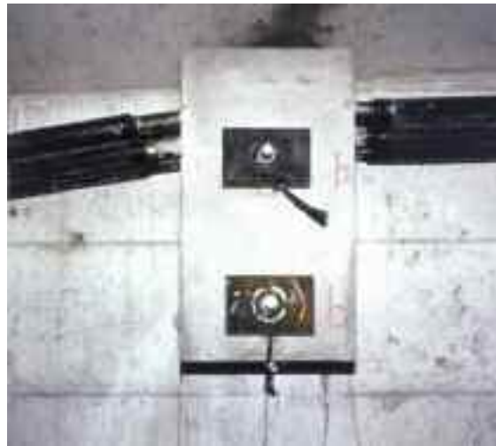
Photo n° 42 : déviateur de type bossage au pont sur l'Arve n°2 (photo LRPC)
