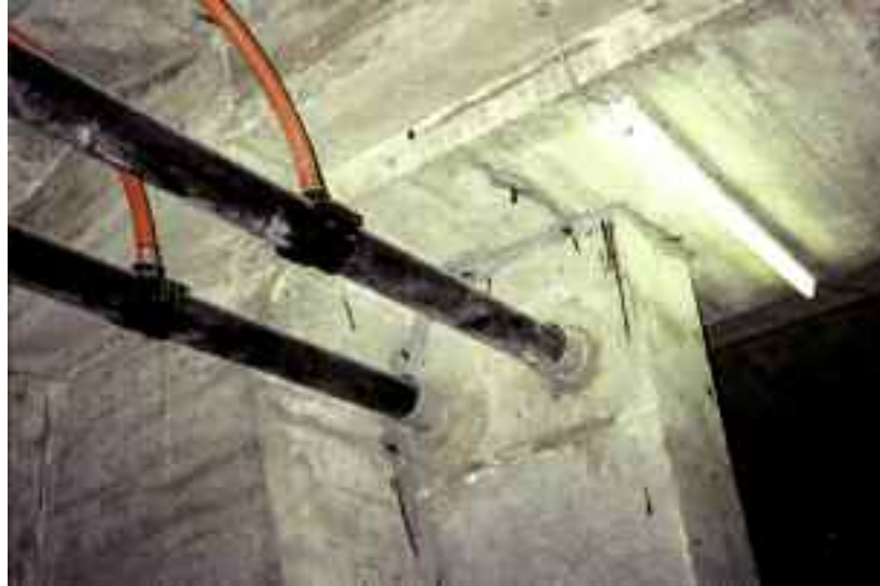
Photo n° 39 : injecteurs en place le long de la reprise de bétonnage au pont de Labéraudie (crédit photo D. Poinéau)
