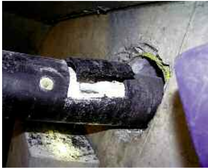
Photo n° 17 : fenêtrage sur une gaine en PEHD montrant un coulis blanchâtre n'ayant pas fait prise complètement (crédit photo DDE de la Réunion)
