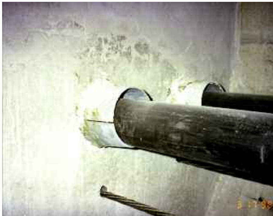
Photo n° 45 : tube métallique de déviation fendu au pont de Châlons-en-Champagne (crédit photo Sétra)
