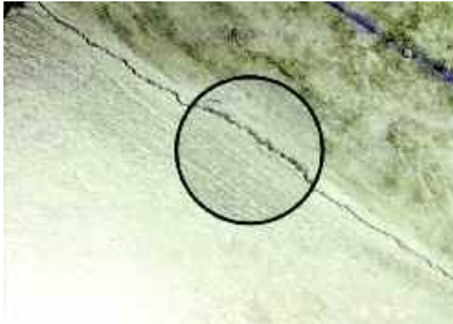
Photo n° 92 : fissure au niveau d'une reprise de bétonnage due aux vibrations (crédit photo D. Poineau)
