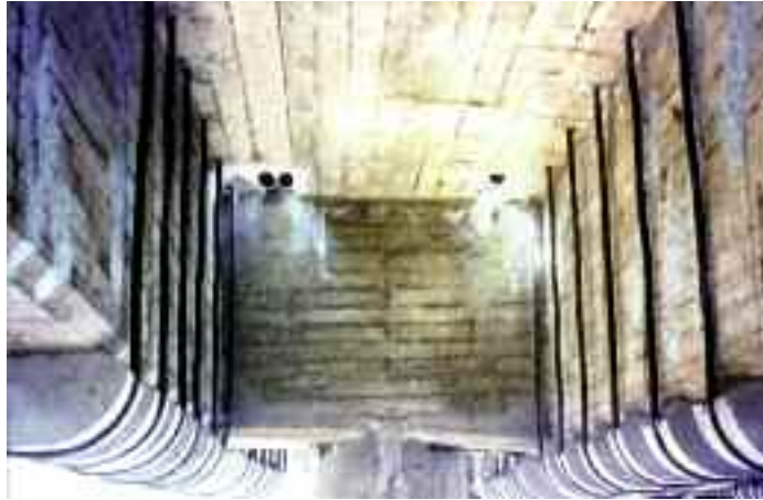
Photo n° 48 : étriers actifs en monotorons placés symétriquement de part et d'autre des nervures hautes (crédit photo Freyssinet)
