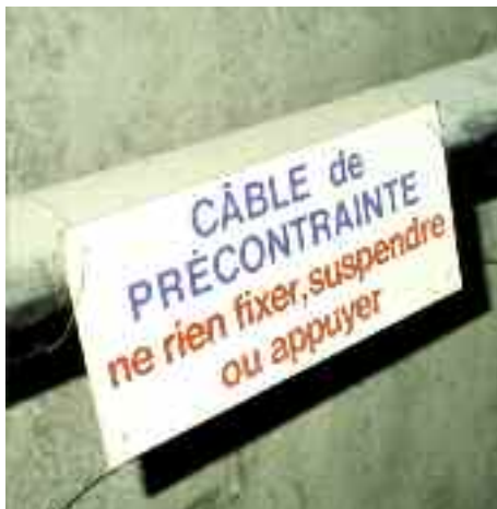
Photo n° 135 : panneau apposé au viaduc de la Darse sur les câbles de la précontrainte additionnelle (crédit phot D. Poineau)
