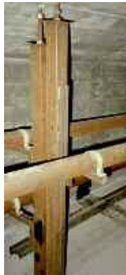
Photo n° 133 : dispositif antivibratoire non correctement protégé contre la corrosion (crédit photo D. Poineau)
