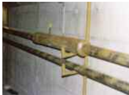
Photo n° 67 : conduits métalliques et vase d'expansion au pont de Bayonne (photo LRPC)
