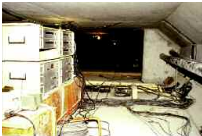
Photo n° 152 : dispositifs de mesures pour le contrôle de travaux de réparations (crédit photo Sétra)
