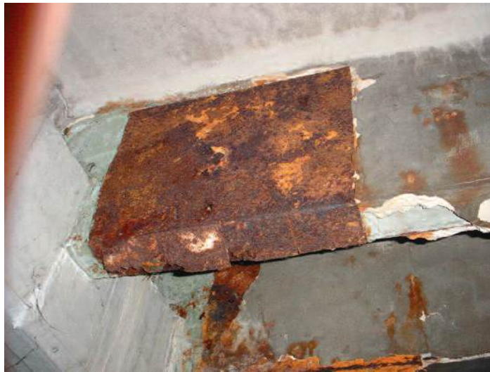
Photo n° 55 : désordres de tôles collées (crédit photo Sika)
