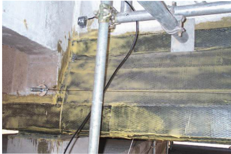
Photo n° 37 : renforcement en tissu composite des abouts des poutres du pont sur la Drôme (crédit photo RCA - M. Trouillet)
