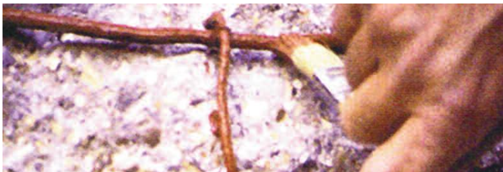
Photo n° 13 : bonne méthode d'application d'un revêtement anticorrosion sur des armatures de BA (crédit photo Weber et Broutin)
