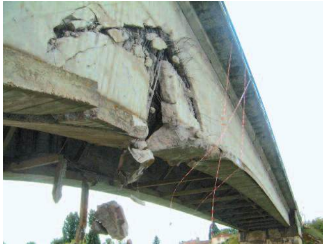
Photo n° 3 : conséquences d'un choc de bateau sur le tablier d'un pont en béton armé (crédit photo CETE de Lyon)
