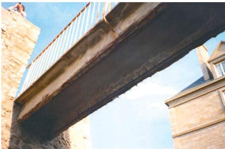
Photo n° 4 : état avancé de corrosion des armatures d'une passerelle piétons (crédit photo D. Poineau)
