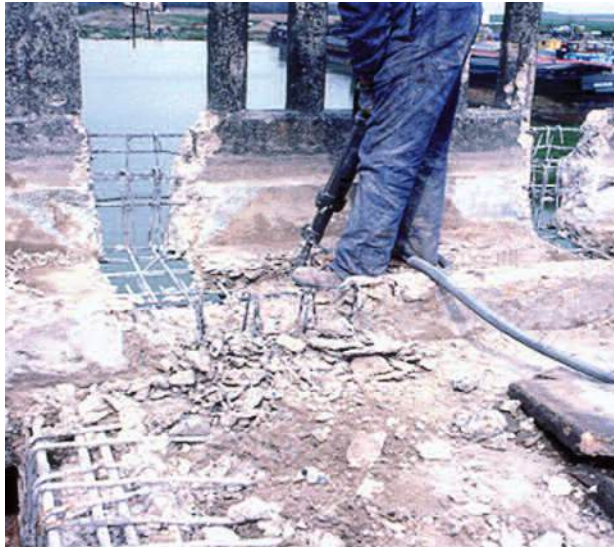
Photo n° 9 : agressivité du marteau-piqueur sur les armatures de béton armé de faible ou moyen diamètre (crédit photo D. Poineau)
