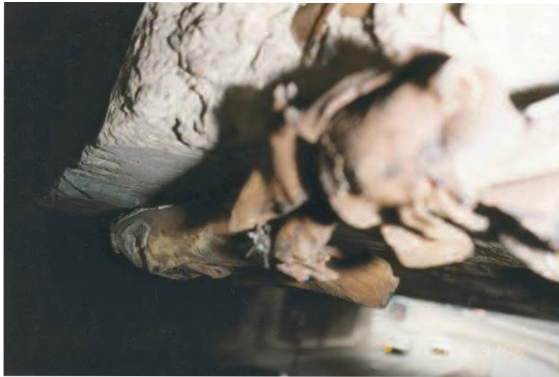
Photo n° 27 : tôle collée sous le talon d'une poutre de rive et endommagée par les chocs de véhicules hors gabarit (crédit photo D. Poinéau)
