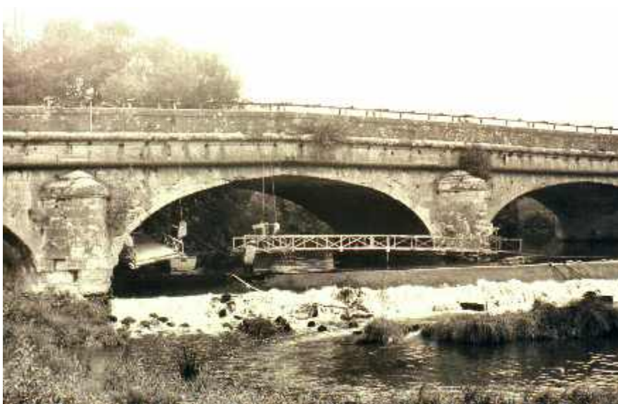
Photo n° 89 : pont surbaissé de Favernay qui pourrait être compatible (après réparations) avec une dalle générale appuyée sur le remplissage (crédit photo DDE 70)
