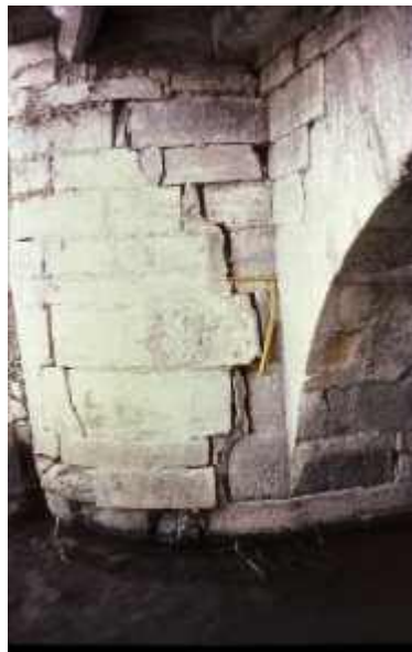
Photo n° 92 : désordres dus à l'appui de l'élargissement sur un avant-bec mal fondé (crédit photo LRPC)
