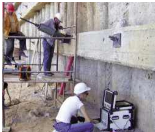
Photo n° 66 : contrôle à l'aide de l'analyse de la réponse vibratoire des tirants d'une paroi (crédit photo A. Bouineau)
