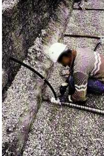
Photo n° 46 : mise en place d'armatures de précontrainte - cf. le nota 1 (crédit photo DDE 52)
