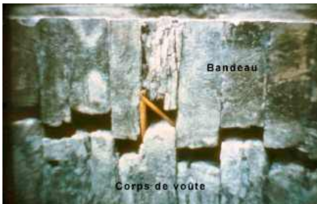
Photo n° 33 : combinaison de plusieurs désordres (décollement du bandeau, écrasement et fendage de pierres...) (crédit photo LAPC)
