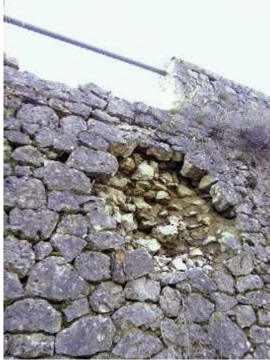
Photo n° 2 : effondrement partiel d'un mur (crédit photo Cofex Littoral)
