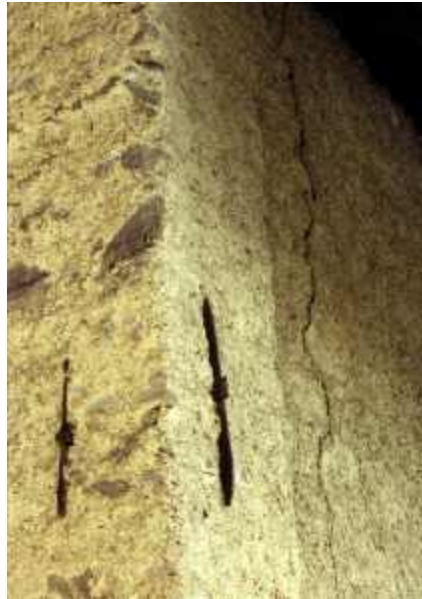
Photo n° 36 : tirants d'enserrement d'un bâtiment dans les Hautes-Alpes (crédit photo D. Poineau)
