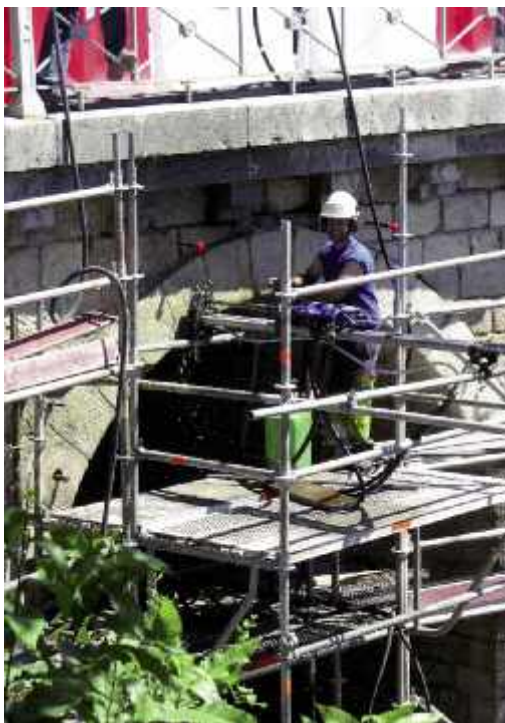
Photo n° 59 : forage du bandeau et de la voûte au pont des Abarines (crédit photo Cofex Littoral)
