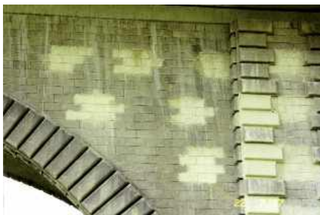
Photo n° 65 : pont dit de 100 mètres aspect des parties restaurées, le ravalement des maçonneries n'ayant pas été prévu au marché (crédit photo DDE 52)
