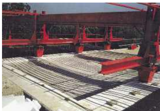
Photo n° 98 : équipement mobile utilisé pour la réalisation de la dalle générale d'élargissement du pont dit de 100 mètres (crédit photo DDE 52)
