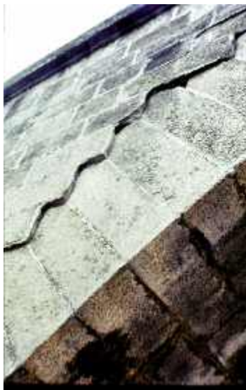
Photo n° 32 : décollement entre le tympan et le bandeau du pont du nid d'oise à Clisson (crédit photo CETE de l'Ouest - Jacques Billon)
