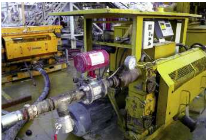
Photo n° 24 : détail d'un dispositif de mesure de la pression et du débit d'injection (crédit photo DIMTI)
