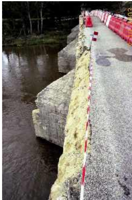
Photo n° 1 : résultat d'un choc sur le parapet d'un pont en maçonnerie (crédit photo Cofex Littoral)
