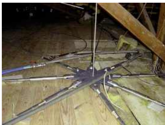
Photo n° 45 : pièce centrale permettant la mise en tension des tirants fixés sur les différentes plaques d'ancrage
