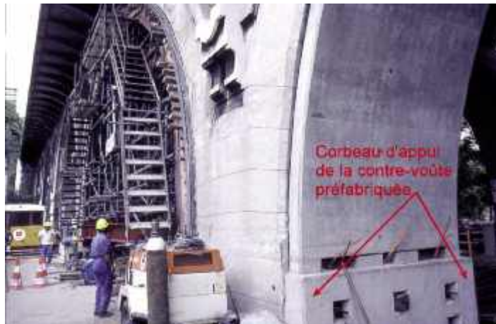
Photo n° 70 : longrine d'appui en partie basse de la contre-voûte préfabriquée du pont de Levallois (crédit-photo D. Poineau)
