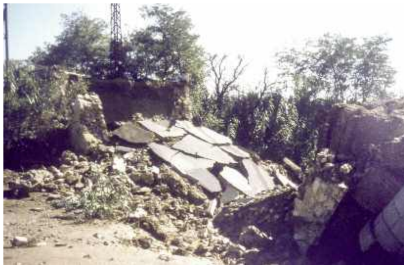
Photo n° 84 : effondrement du pont du Réart causé par des travaux sur les fondations (crédit photo D. Poineau)
