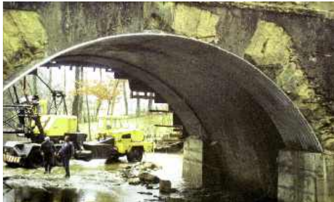
Photo n° 72 : coffrage avec des éléments de buse, ici uniquement au niveau de la base des voiles en béton armé de renforcement des murs tympan (crédit photo Michel Daugreilh) 17
