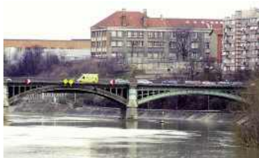
Photo n° 77 : vue du pont de Saint-Ouen et du ceinturage de la pile (crédit photo J. Mossot -Structurae)
