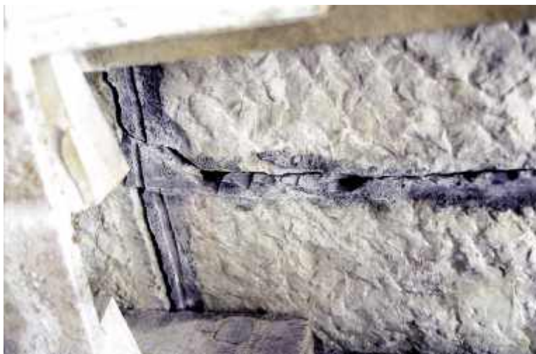
Photo n° 83 : ouverture du joint accompagnée d'un déplacement transversal en l'absence d'épingles ou de tirants d'enserrement (crédit photo P. Vion)
