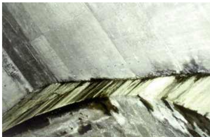
Photo n° 95 : mauvaise étanchéité du joint longitudinal entre l'ancien et le nouvel ouvrage (crédit photo CDDA Corse)
