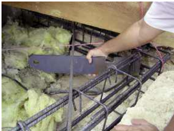
Photo n° 44 : chaînage périphérique en tête des murs extérieurs et plaque d'ancrage scellée dans le chaînage lors du bétonnage de ce dernier
