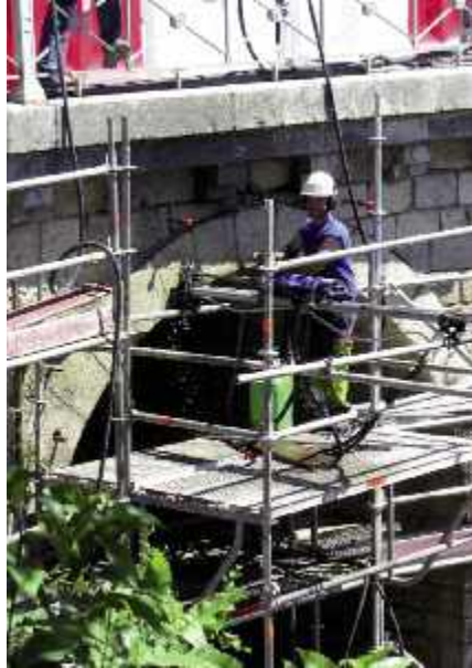
Photo n° 49 : forage dans le corps de voûte marteau hors trou (crédit photo Cofex Littoral)
