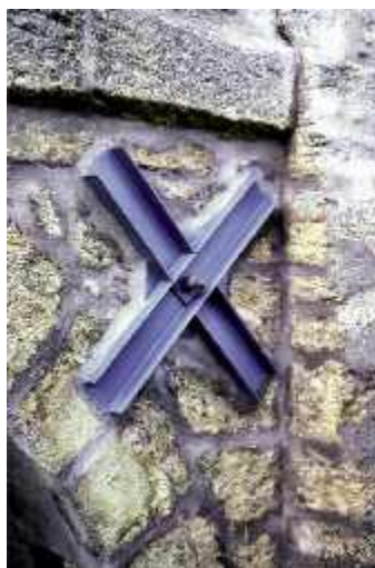
Photo n° 41 : tirant d'enserrement avec tête d'ancrage en croix de Saint-André. La protection de l'extrémité de la barre n'est pas assurée (crédit photo J.L. Michotey)
