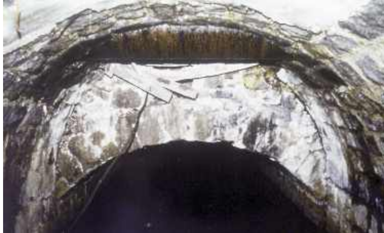
Photo n° 96 : mauvaise réalisation du joint longitudinal entre l'ancien et le nouvel ouvrage et débouchés superficiels très différents (crédit photo CDOA Corse)
