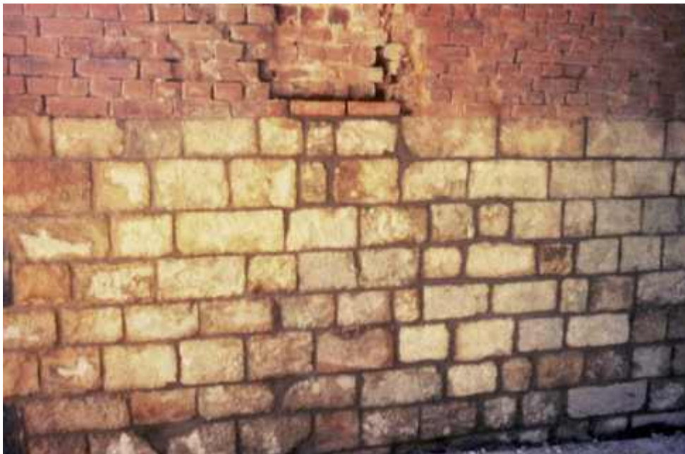
Photo n° 7 : travaux de réfection terminée pour la maçonnerie de moellons assisés (crédit photo JL. Michotey)
