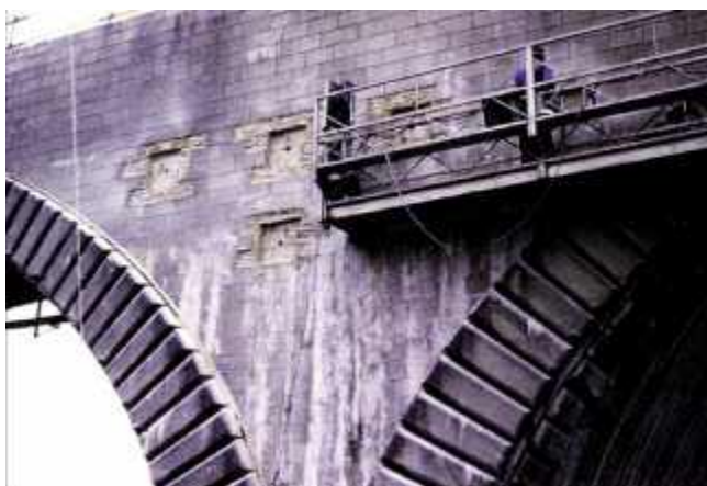
Photo n° 63 : pont dit de 100 mètres, niches de logement des ancrages (crédit photo DDE 52)
