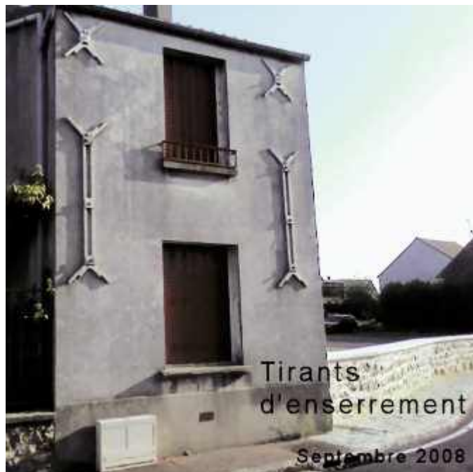
Photo n° 37 : tirants d'enserrement d'un pavillon en région parisienne (crédit photo D. Poineau)
