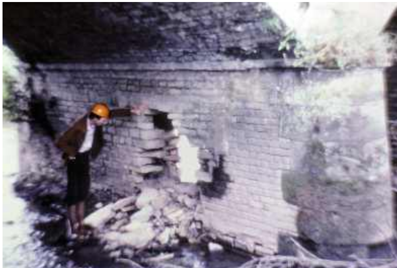
Photo n° 3 : effondrement partiel d'une pile en maçonnerie (crédit photo DDE 70)
