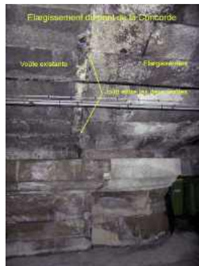
Photo n° 94 : détail de l'élargissement du pont de la Concorde (crédit photo D. Poineau)
