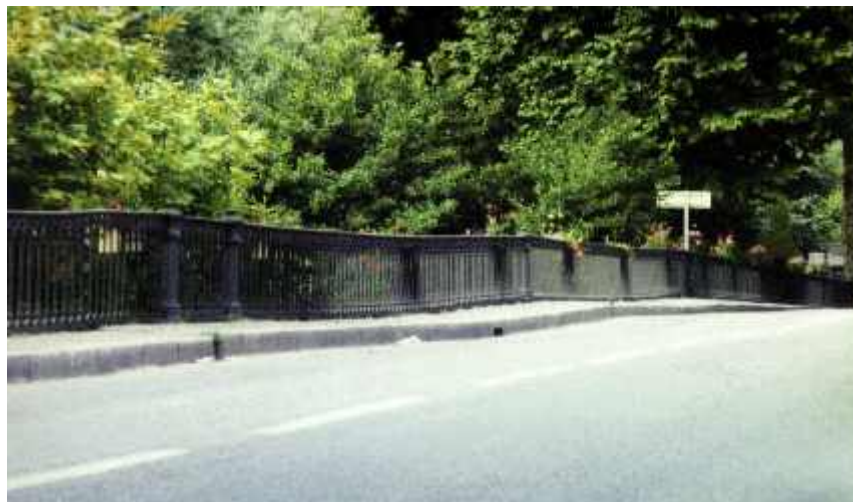
Photo n° 80 : les déformations du pont de Villeneuve-Loubet avant travaux (crédit photo CG 06)
