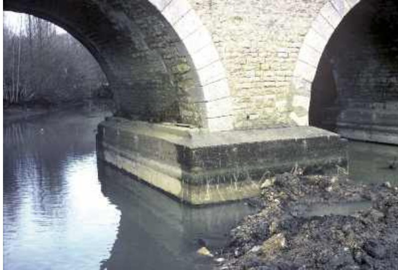
Photo n° 16 : élargissement de la base d'un appui par un voile en béton. Bien souvent, un "cache-misère" donnant l'illusion de la sécurité (crédit photo JP. Levillain)
