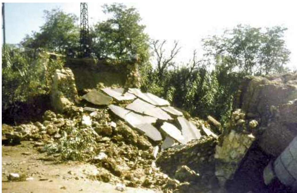
Photo n° 12 : effondrement d'un pont en maçonnerie en cours de travaux (crédit photo D. Poineau)
