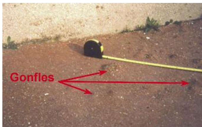
Photo n° 44 : gonfles sur un revêtement de trottoir en asphalte (crédit photo D. Poineau)
