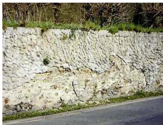
Photo n° 29 : désordres dus à la réalisation d'un enduit sur un mur de soutènement alors que la maçonnerie est exposée à l'eau sur ses autres faces (crédit photo D. Poineau)
