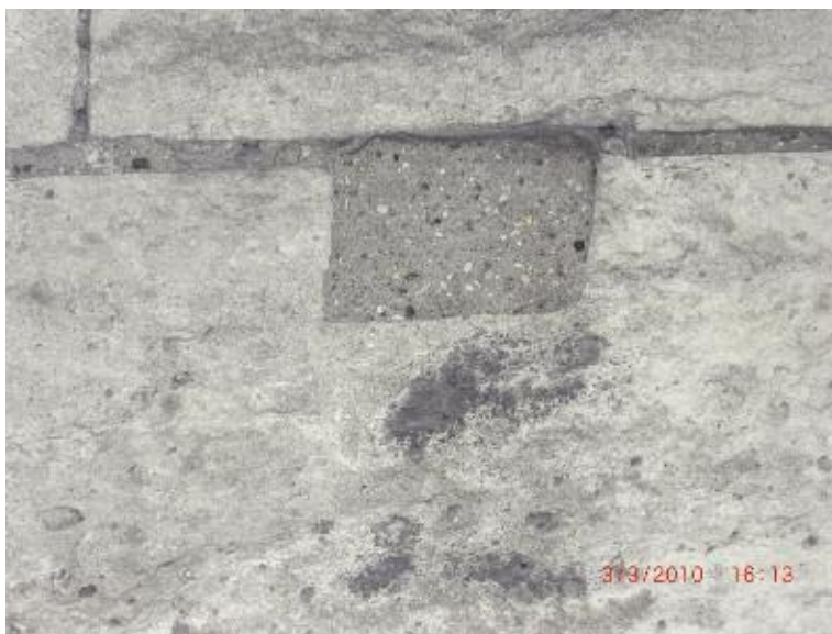
Photo n°18 : réparation locale ancienne avec un mortier à base de ciment (crédit photo D. Poineau)
