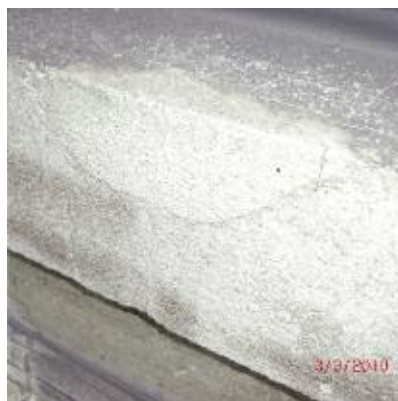
Photo n° 21 : refouillement en sifflet inadapté pour une réparation locale (crédit photo D. Poineau)
