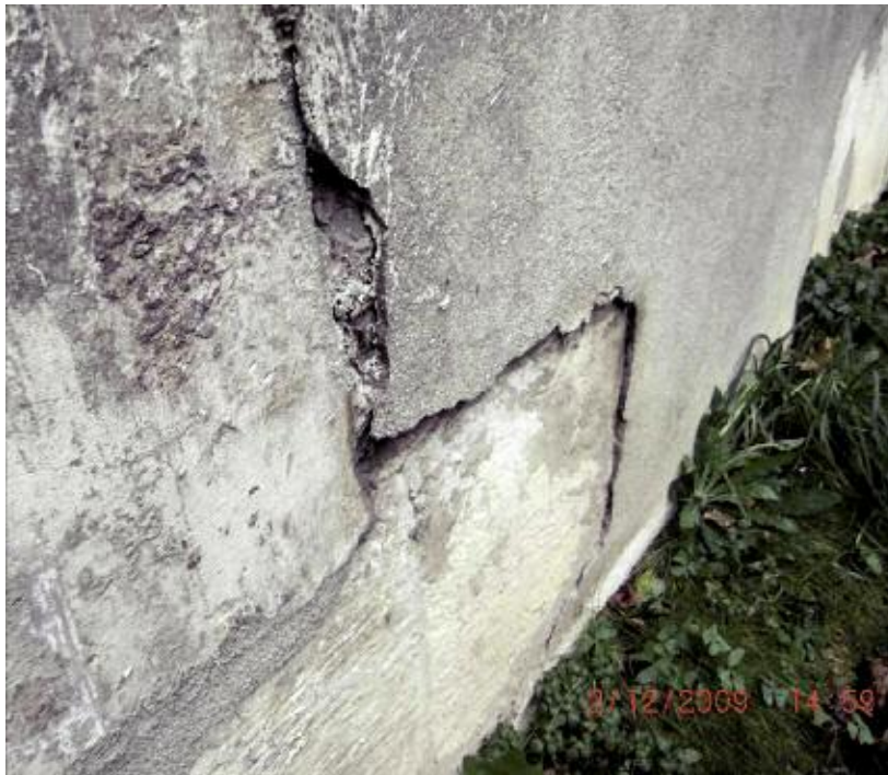
Photo n° 30 : décollement d'un enduit inadapté (crédit: photo D. Poineau)
