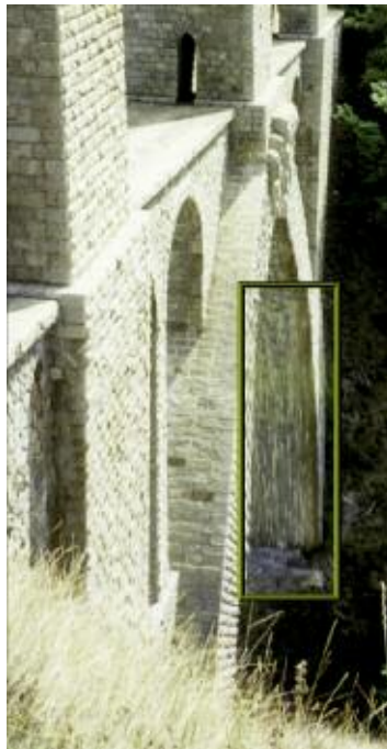
Photo n° 48 : traces de calcite à l'intradors de l'arc brisé du viaduc de Fontpédrouse (crédit photo D. Poineau)
