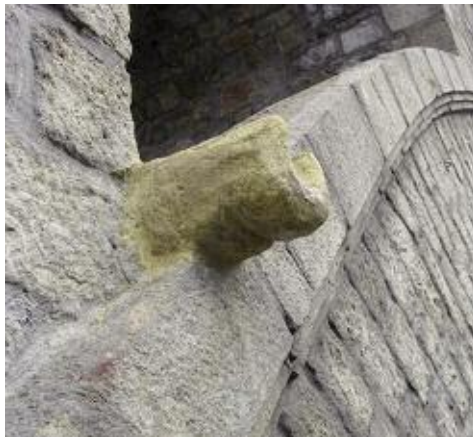
Photo n° 51 : gargouille à l'extrados de l'arc du pont des Albarines (crédit photo CG du Gard)
