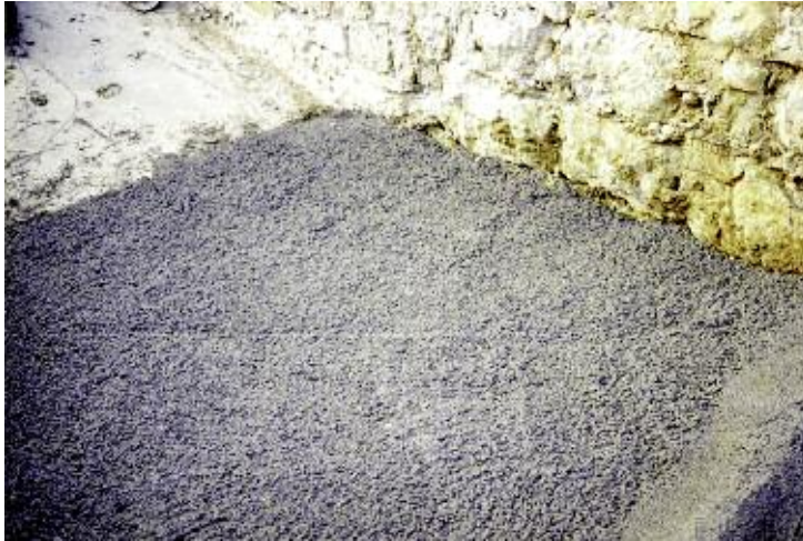
Photo n° 32 : béton très léger de remplissage au-dessus d'une pile du pont de Villeneuve-Loubet (crédit photo P. Vian)
