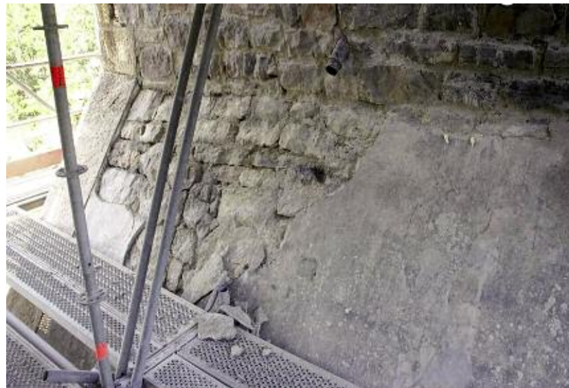
Photo n° 11 : dégarnissage des joints de l'extrados au pont des Abarines (crédit photo CG du Gard)
