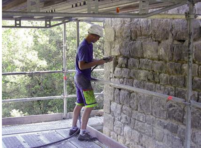
Photo n° 10 : dégarnissage des joints au marteau pneumatique au pont des Abarines (crédit photo CG du Gard)
