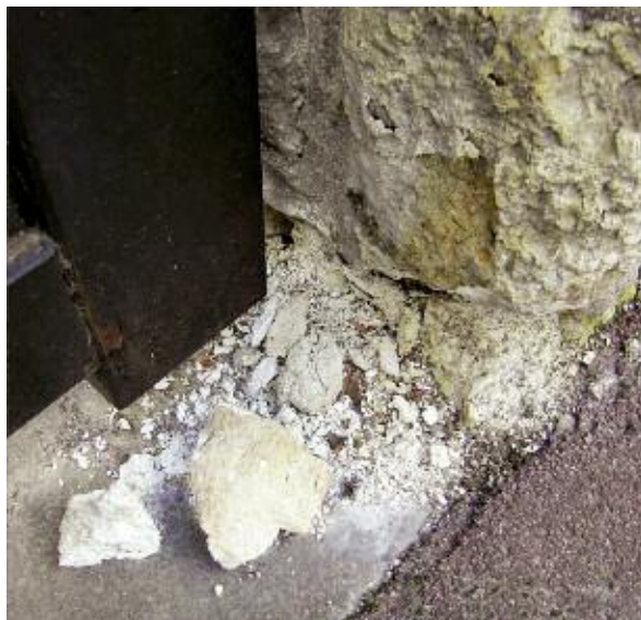
Photo n° 53 : désordres dus à des remontées d'humidité et de sels et survenus juste après une période de gel (crédit photo D. Poineau)
