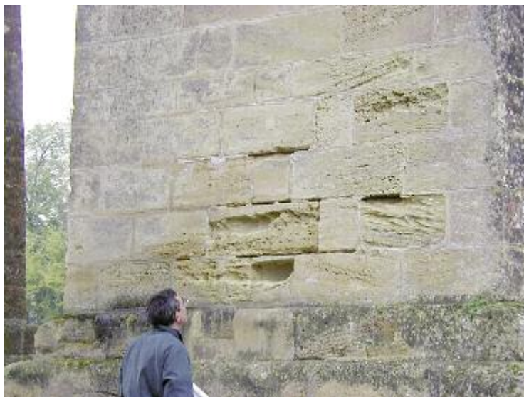
Photo n° 23 : effets des remontées d'humidité et de sels dans les piles (crédit photo D. Poineau)
