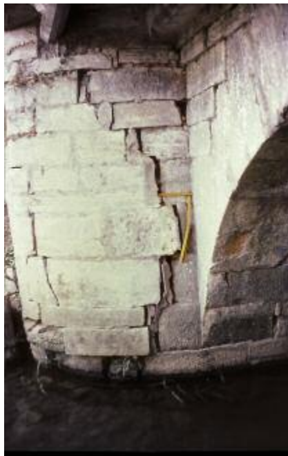
Photo n° 38 : fracturation et déversement d'un avant-bec chargé par un élargissement mal conçu (crédit photo LRPC)
