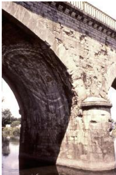
Photo n° 25: utilisation de pierres calcaires sensibles au gel (crédit photo LRPC)
