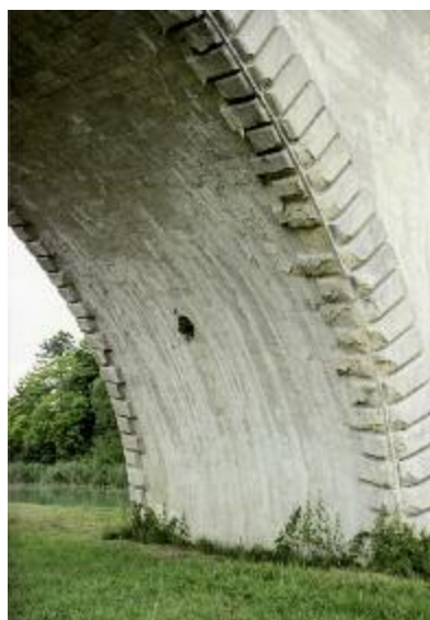
Photo n° 16 : coulures d'humidité et de calcite et pierres sensibles au gel sous un ancien pont ferroviaire (crédit photo DDE 52)
