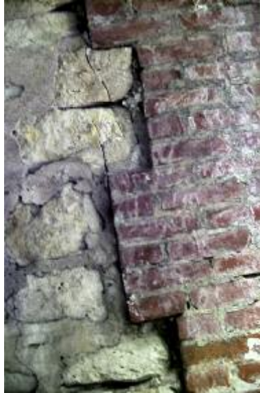
Photo n° 6 : fissure des moellons dans une voûte composite associant la pierre et la brique (crédit photo J. M. Michotey)
