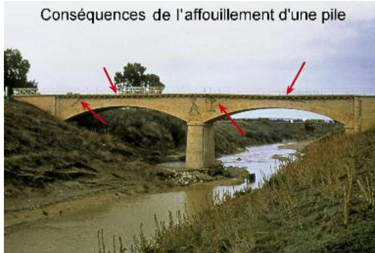
Photo n° 41 : tassement d'une pile dû à un affouillement (crédit photo M. Virlogeux)
