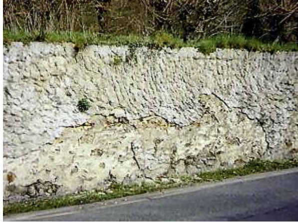
Photo n° 46 : désorganisation de l'enduit ciment et du mur de soutènement en maçonnerie (crédit photo D. Poineau)
