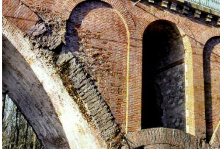
Photo n° 35 : désorganisation des briques du bandeau due à l'eau et au gel (crédit photo J. M. Michotey)
