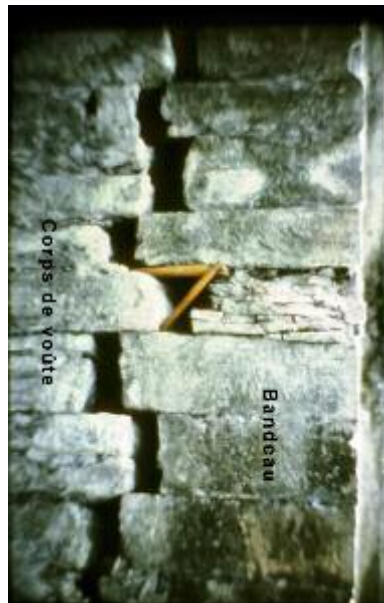
Photo n° 7 : fracture à la jonction entre le bandeau et la voûte avec écrasement d'une des pierres de la clé de voûte (crédit photo LRPC)
