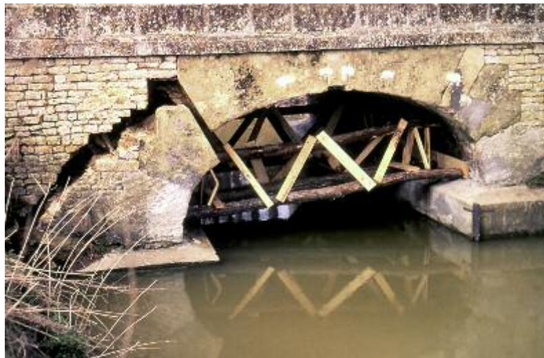
Photo n° 40 : rupture due à l'affouillement d'une culée (crédit photo LRPC)
