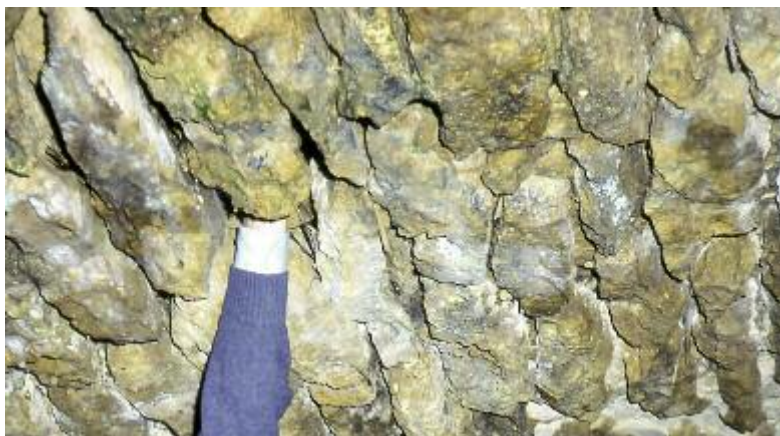
Photo n° 10 : désorganisation quasi-totale des joints (crédit photo J. M. Michotey)
