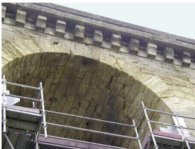
Photo n° 22 : effets sur la pierre du passage des eaux de pluie au travers du remblai et des murs de tête (crédit photo D. Poineau)
