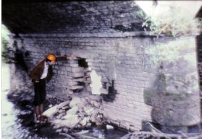
Photo n° 9 : désorganisation de la maçonnerie d'une pile (photo CDDA 70)
