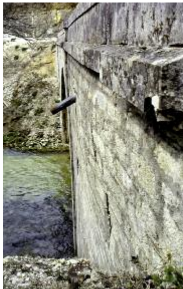
Photo n° 5 : déformation du mur en retour d'un pont en maçonnerie (crédit photo J. M. Michotey)
