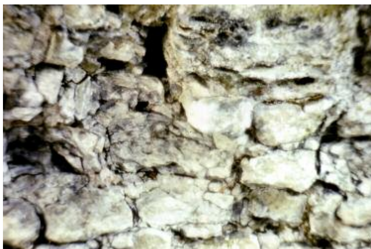
Photo n° 14 : exemple d'emploi de matériaux inadaptés : pierres et mortier de hourdage (crédit photo LRPC)
