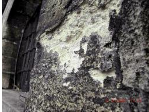
Photo n° 27: desquamation de pierres calcaires de l'église de Villejuif (crédit photo D. Poineau)
