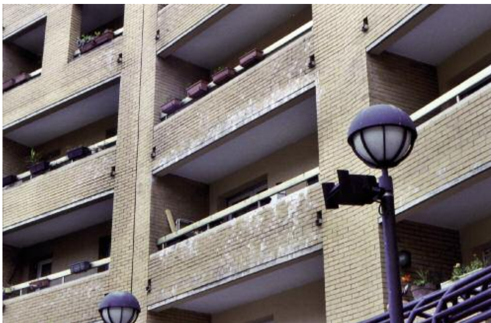
Photo n° 30 : efflorescences très inesthétiques [crédit photo D. Poineau]
