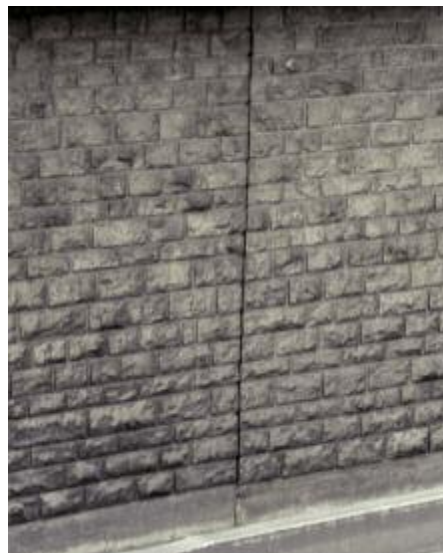
Photo n° 32 : joint de fractionnement (photo D. Poineau)
