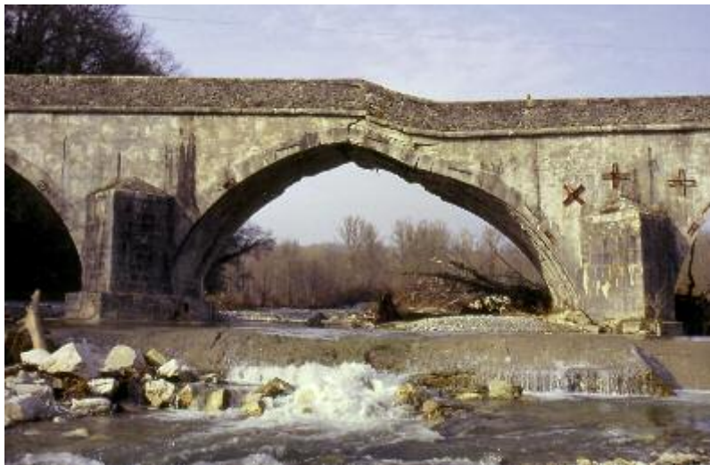
Photo n° 42 : rupture due à un affouillement d'une pile (Crédit photo Jean-Louis Michotey)
