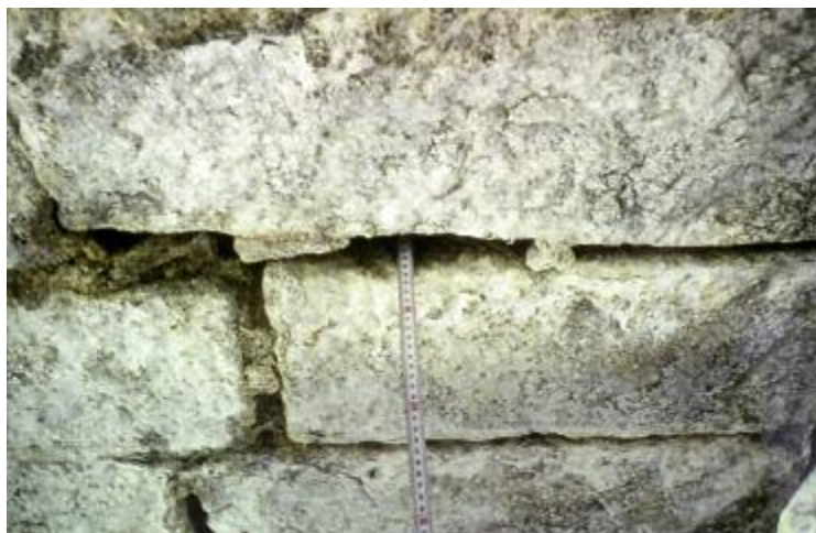
Photo n° 15 : dissolution du mortier des joints (crédit photo LRPC)
