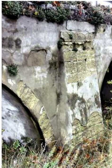
Photo n° 47 : exemple de travaux d'enduisage inadaptés à la maçonnerie (crédit photo D. Poineau)
