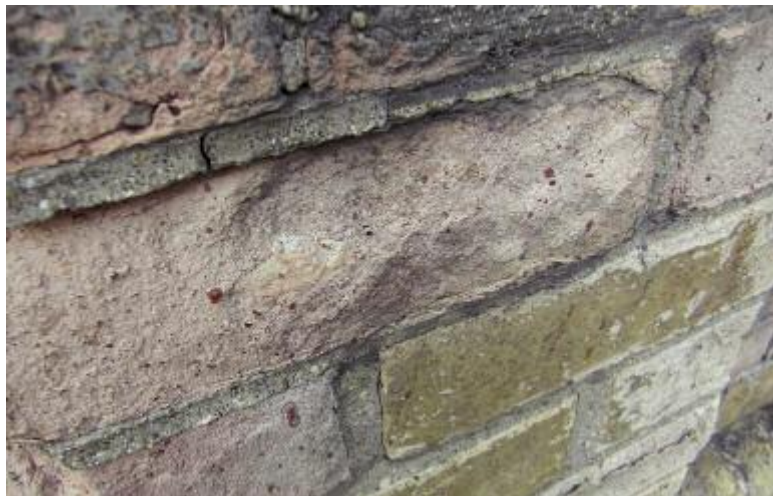
Photo n° 29 : altération de briques de parement (crédit photo D. Poineau)
