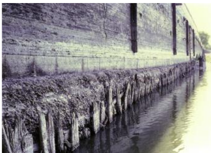
Photo n°43 : dégradation par abrasion d'une pièce de bois de fondation (crédit photo J. P. Levillain)
