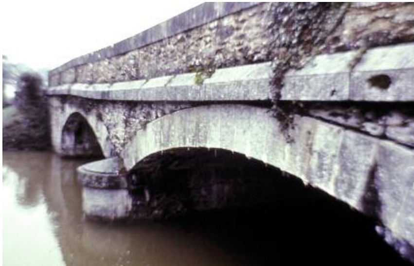
Photo n° 4 : déformation liée à un affouillement sous la fondation de la pile mettant en danger le pont de Régereau sur le Vicoïn (crédit photo J-P Levillain)
