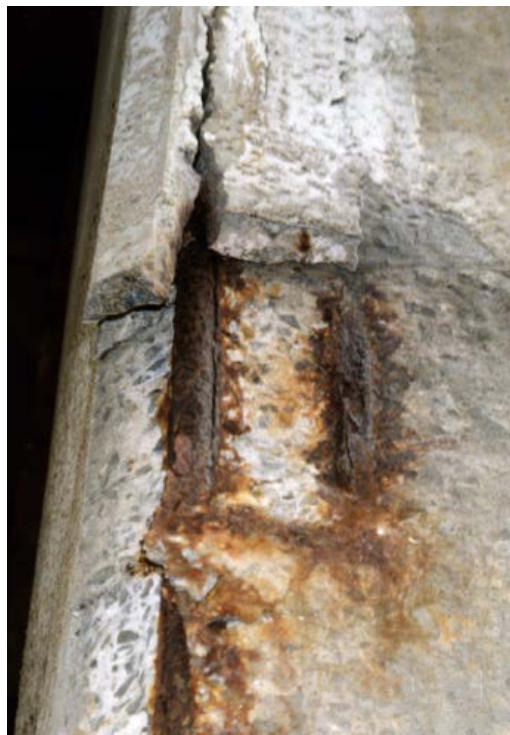
Photo n° 1 : désordres dus à la corrosion des armatures (crédit photo Poineau)
