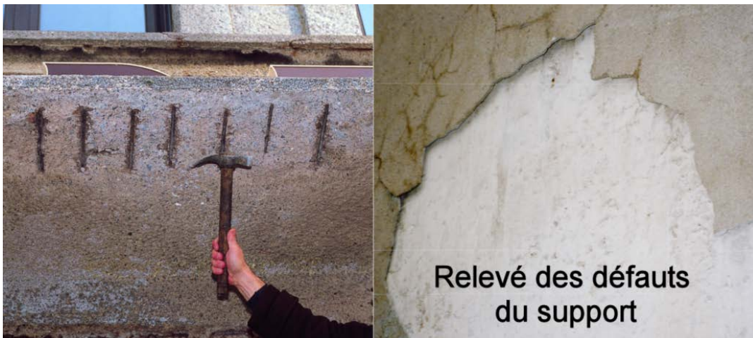
Photo n° 27 : relevé des défauts du support (crédit photo Parexlanko et Poineau)
