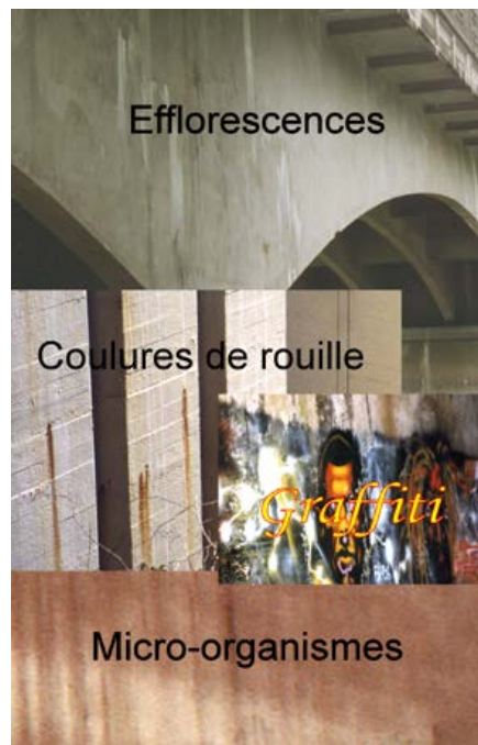
Photo n° 8 : exemples de défauts d'aspect (crédit photo Poineau)
