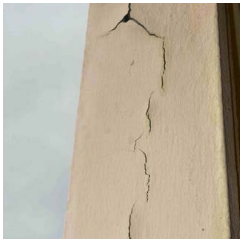
Photo n° 17 : éléments de faible section et revêtement de protection endommagé (crédit photo Poineau)
