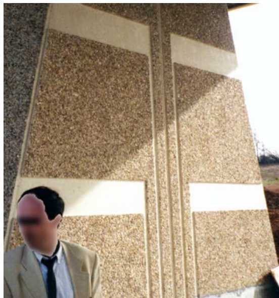
Photo n° 37 : exemple de joints de fractionnement dans le revêtement d'une pile d'un pont (crédit photo Poineau)
