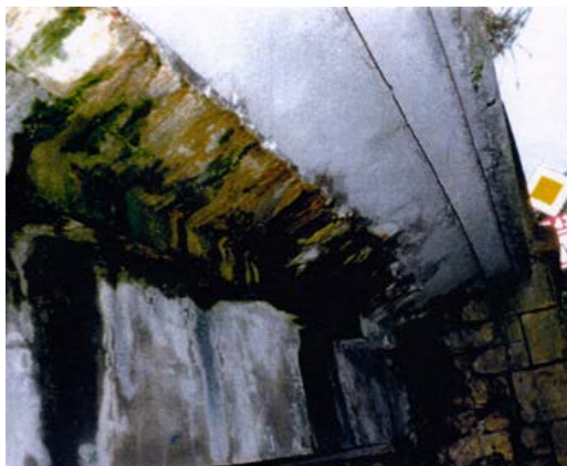
Photo n° 14 : exemple de fissure constamment humide (crédit photo DDE 54)
