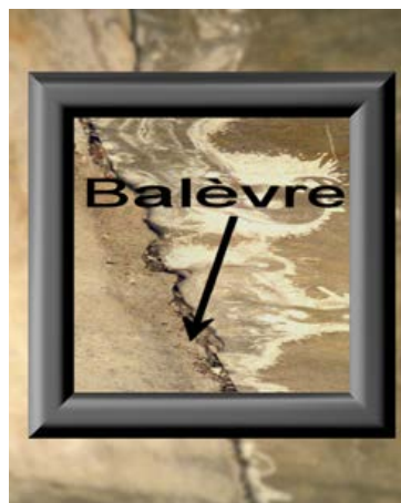
Photo n° 6 : exemple de défaut géométrique (crédit photo Poineau)
