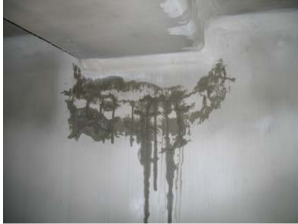
Photo n° 47 : fuite sur la paroi d'un coulage (crédit photo Poineau)
