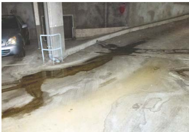
Photo n° 32 : fuites à la jonction d'une rampe et d'un plancher d'un cuvelage (crédit photo Poineau)
