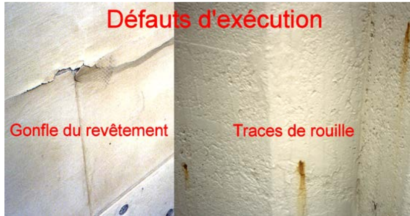
Photo n° 46 : défauts d'exécution pouvant apparaître avec le temps (crédit photo Poineau)
