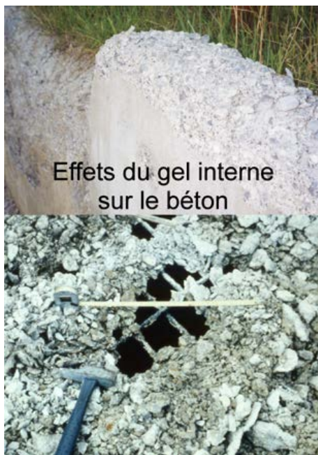
Photo n° 2 : désordres dus au gel interne du béton (crédit photo Poineau)
