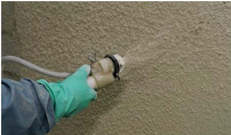
Photo n° 35 : réalisation d'un enduit monocouche avec une machine à projeter (crédit photo Parexlanco)
