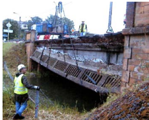
Photo n° 15 : conséquence de la circulation de l'eau au travers d'une fissure (crédit photo DDE 54)
