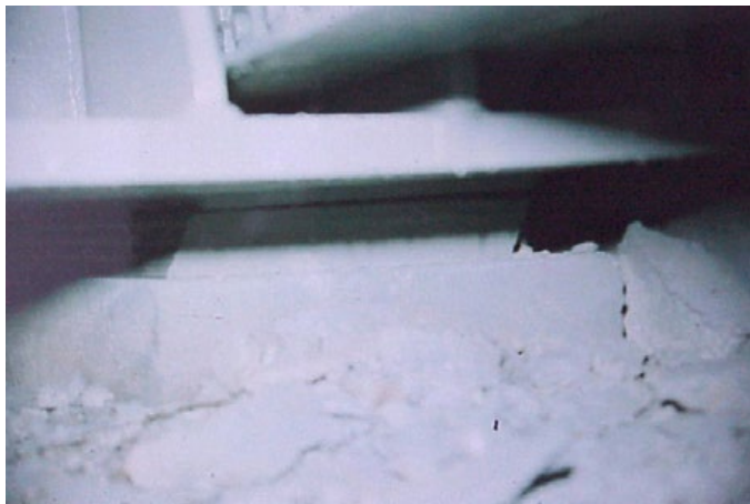
Figure 105 : Défaut de contact d'un appareil néoprène par défaut de parallélisme des surfaces (photo Jean-Paul PERSY).
