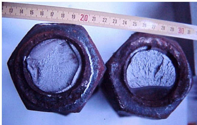
Figure 37 : Corrosion fissurante sur assemblage boulonné de tige d'ancrage (photo Jean-Paul PERSY).
