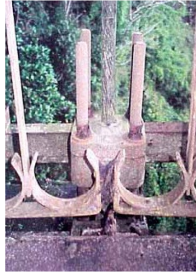
Fig. 69 : Corrosion spécifique des écrous d'une attache basse de suspension de pont suspendu (photo Menou - LCPC).
