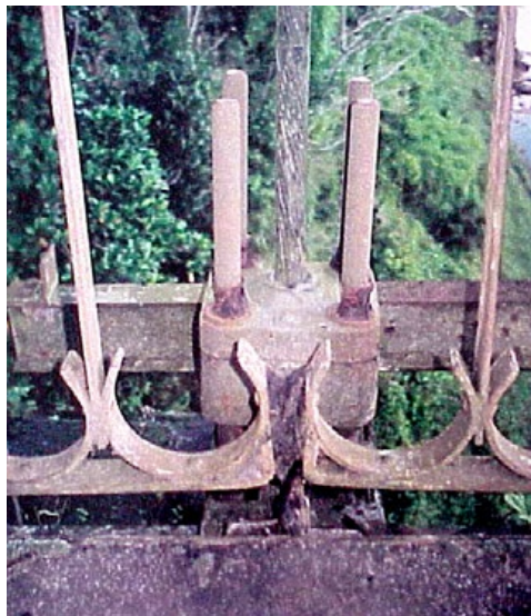
Figure 36 : Corrosion d'écrous (photo Jean-Paul PERSY).
