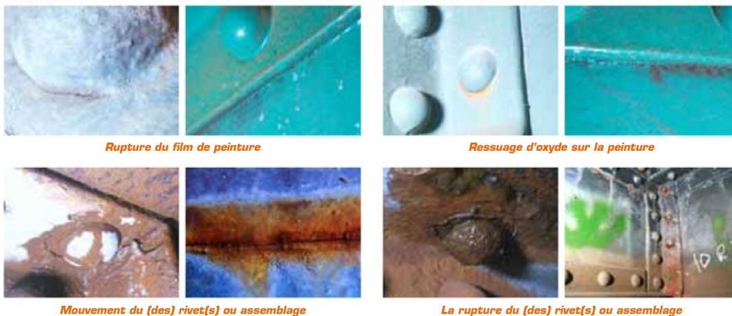
Fig. 65 : Dégradation des rivets (à gauche) et assemblages (à droite) par déconsolidation (photos SNCF).
