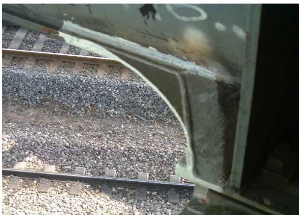
Fig. 95 a et b : Désordre de fatigue et réparation avec gousset d'épanouissement (photos Jean-Paul PERSY).
