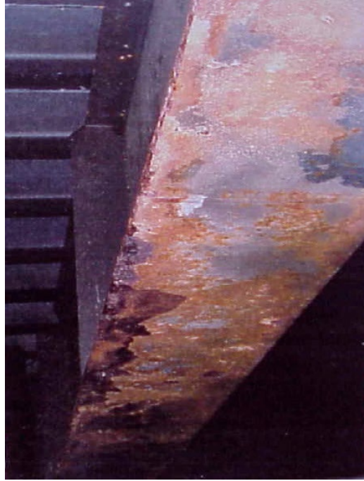
Figure 31 : Enrouillement, et début de corrosion sur zone condensante en sous-face d'une membrure inférieure de pièce de pont (photo Jean-Paul PERSY).
