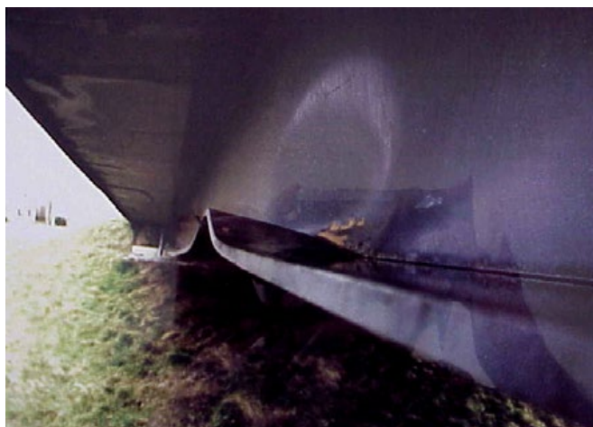
Figure 85 : Choc de véhicule sur ouvrage moderne - déformations de la membrure inférieure et de l'âme de poutre (photo Jean-Paul PERSY).
