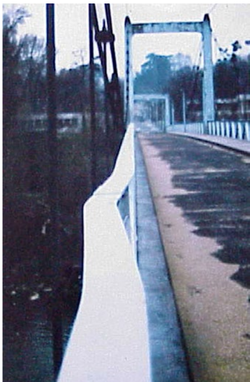
Figure 84 : Flambement de membrure supérieure de la poutre de rigidité hors du plan (photo Jean-Paul PERSY).
