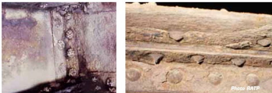
Fig. 64 : Corrosion de rivets (photo Jean-Paul PERSY).
