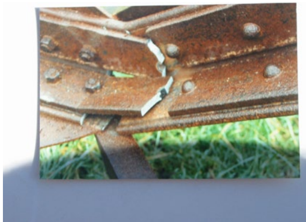
Figure 51 : Rupture plane à fond de filet sur un élément en barre (photo Jean-Paul PERSY).
