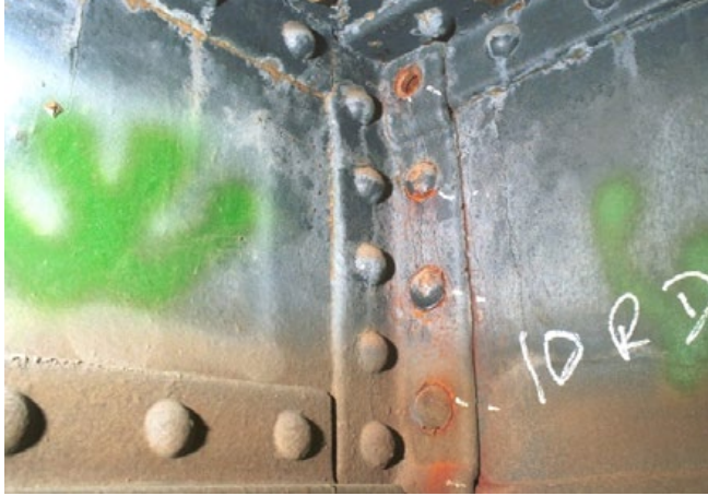
Figure 66 : Différents stades de déconsolidation d'un assemblage rivé (photo SNCF).
