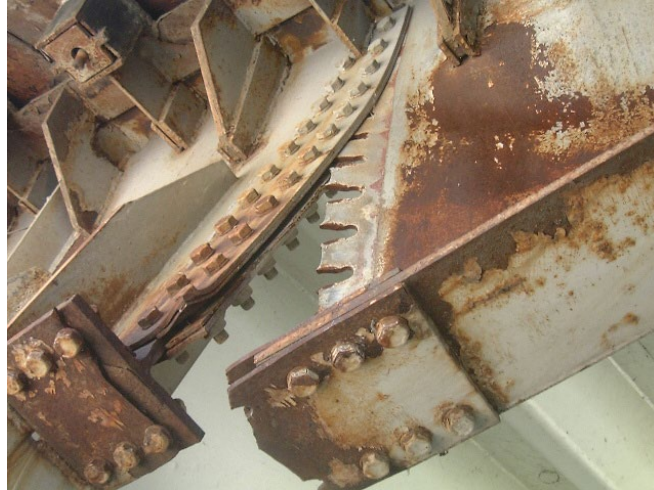
Figure 75 : Sur ouvrage d'art, rupture par dépassement des efforts en pression diamétrale pour l'âme, par excès de traction pour le couvre-joint de la membrure inférieure (photo Jean-Paul PERSY).
