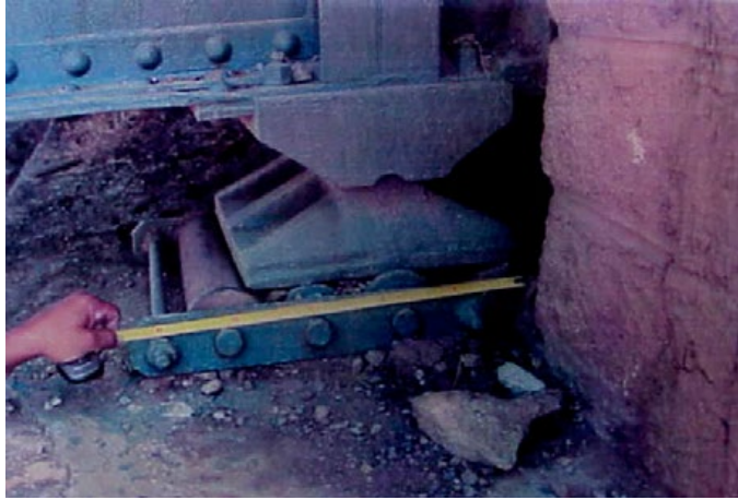
Figure 103 : Cheminement d'appareil d'appui à rouleaux (photo Jean-Paul PERSY).
