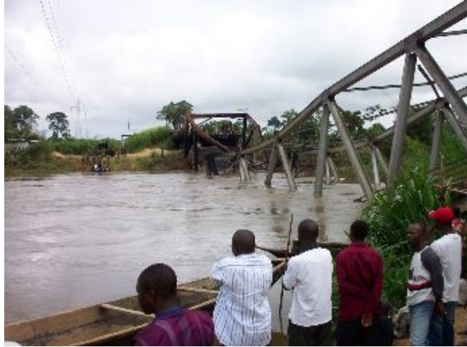
Figure 79 : Pont sur le Mungo - Cameroun - 2 juillet 2004 - incendie d'un camion-citerne d'hydrocarbures (document Internet).
