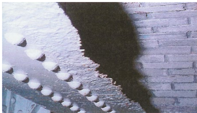
Figure 41 : Membrane inférieure corrodée latéralement, conservée après vérification par calcul et traitement anticorrosion (photo Jean-Paul PERSY).
