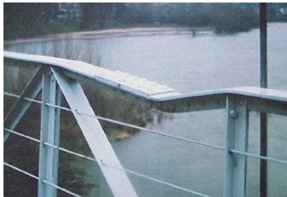
Figure 83 : Flambement de membrure supérieure de la poutre de rigidité dans le plan (photo Jean-Paul PERSY).
