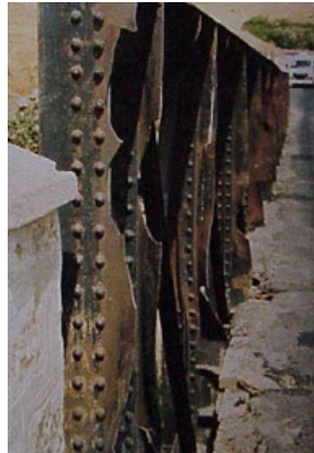
Figure 53 : Ruptures sur acier fragile par chocs de véhicules – acier des années 1925 environ (photo Jean-Paul PERSY).
