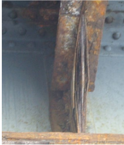
Figure 33 : Corrosion feuillettante d'un gousset sur un ouvrage des années 1960 (photo Jean-Paul PERSY).
