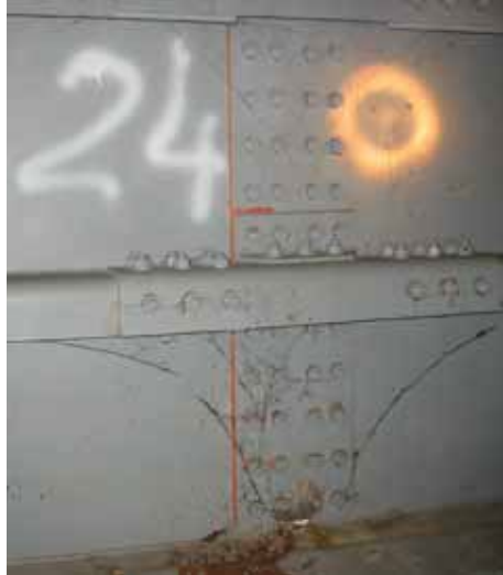
Fig. 71 : Glissement des pièces au niveau d'un joint de rabotage sous effort excessif (effondrement partiel de l'ouvrage). Mise en évidence par rupture du feuil de peinture et mise à nu de la sous couche au minium de plomb (photo Jean-Paul PERSY).
