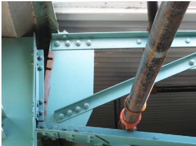
Figure 74 : Rupture par dépassement des efforts en pression diamétrale sur une charpente (photo Jean-Paul PERSY).
