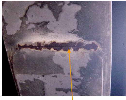
Figure 59 : Fissure frontale d'une semelle additionnelle de membrure inférieure de poutre (photo Jean-Paul PERSY).
