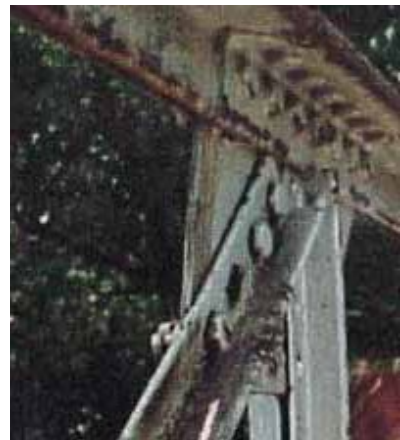
Fig. 70 : Déconsolidation d'un assemblage boulonné non précontraint d'une poutre treillis avec disparition d'un boulon de l'assemblage (photo Jean-Paul PERSY).
