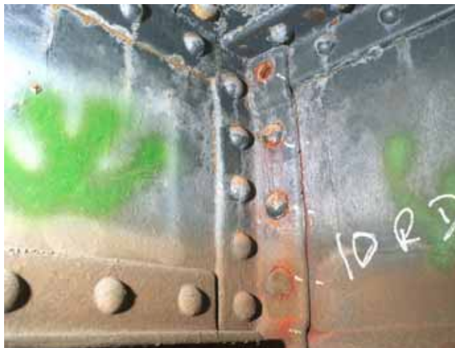
Fig. 93 : Déconsolidation d'assemblage rivé avec rupture de rivet (photo SNCF).
