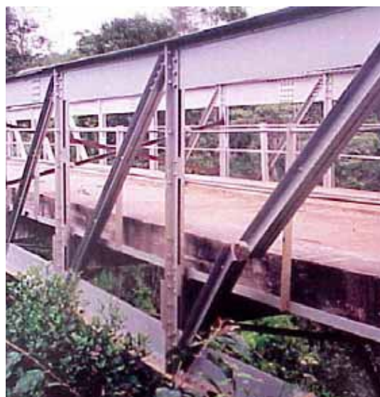
Fig. 21 : Rupture d'une diagonale tendue sur un point de soudure (photo Jean-Paul PERSY).
