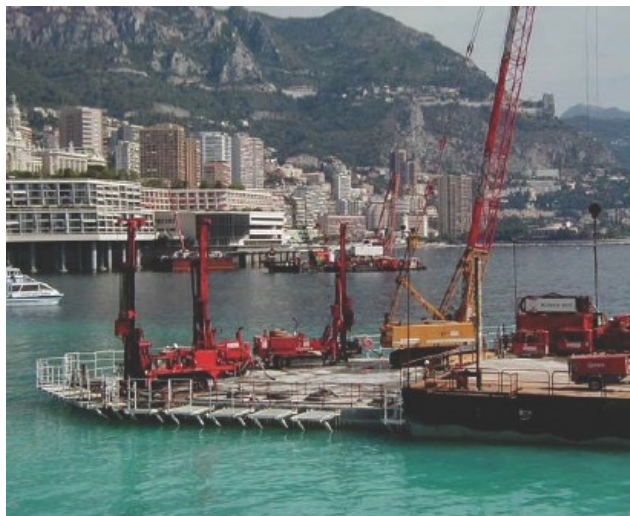
Photo n° 4 : amélioration du sol de fondation de la nouvelle digue de Monaco (photo Solétanche-Bachy).
