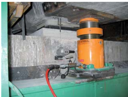
a) Vérin à fort tonnage. Noter le capteur de déplacement, la bague de sécurité (dont il serait souhaitable qu'elle soit à proximité du corps du vérin) et les flexibles souples. Crédit photo P. DANTEC - LRPC de Clermont Ferrand
