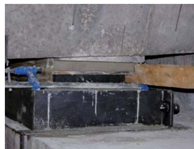
Document SETRA/LCPC (référence § 1.2.4) Crédit photo P. DANTEC - LRPC de Clermont Ferrand Figure 49 : Disposition type pour la réalisation d'un matage, à gauche. Réalisation sur un chantier, à droite.
