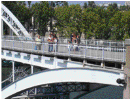
Figure 2 : Rôle du garde-corps. Crédit photo M. Fragnet
