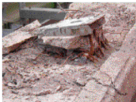
Figure 25 : exemple de désordres autour d'une zone d'ancrage par suite d'emploi de vis fusibles non adaptées. Crédit photo DDE 48
