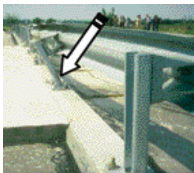
Figure 18-1 : La zone fusible d'une barrière de niveau N. Crédit photo SETRA/CTOA
