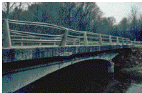
Figure 18-2 : rupture du hourdis de cet ouvrage faute d'avoir mis en place les ancrages fusibles de la BN4 lors d'une réparation. Crédit photo SETRA/CTOA
