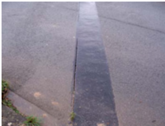
Figure 9 a : Fissure au droit du trait de scie
