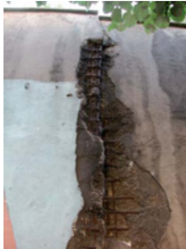
Figure 12 : Epaufrures des lèvres par mise en contact suite à un mouvement de structure ou d'insuffisance de hiatus pour la dilatation, ou une combinaison des deux. Crédit photo SETRA - G. Haiun
