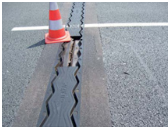
Figure 8 : L'arrachement sous trafic de l'élément manquant aurait pu être à l'origine d'un accident (noter la condamnation au trafic de la voie concernée). Crédit photo M. Fragnet
