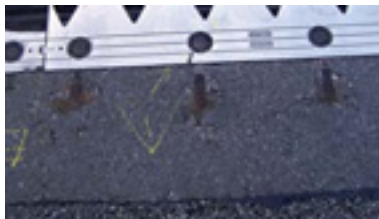
Rupture de dent, fissure dans le métal, fissuration du solin
