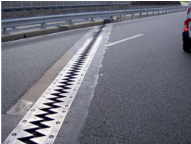
Figure 11 : Lors de la visite, on doit se demander si ce joint n'est pas trop ouvert eu égard à la température de l'ouvrage au moment de la visite. Crédit photo M. Fragnet
