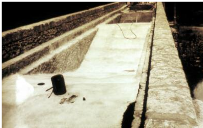
Photo n° 35 : voûtes après la réalisation d'un support en BA de la chape d'étanchéité (crédit photo LRPC)
