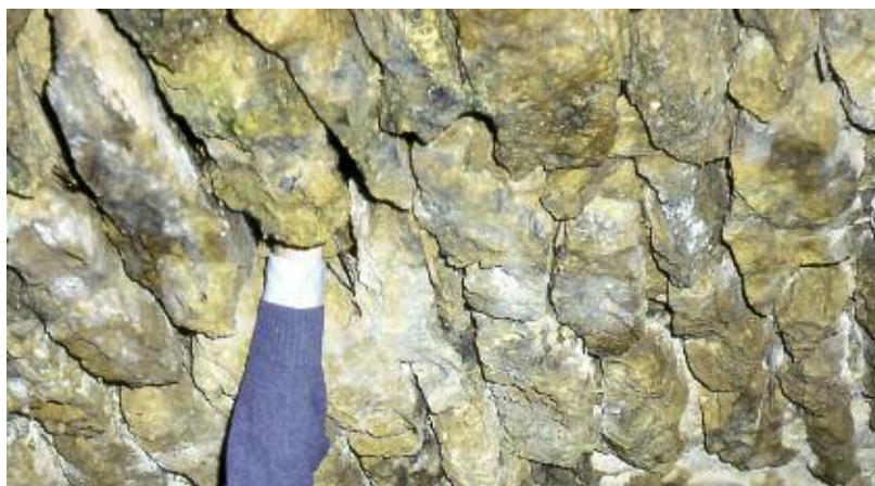
Photo n° 4 : disparition des joints et du mortier de hourdage (crédit photo J.L. Michotey)
