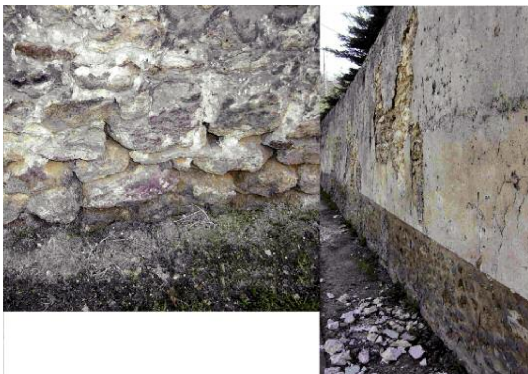
Photo n° 2 : effets des eaux à la base d'un mur et sur l'enduit d'un autre (crédit photo D. Poinéau)
