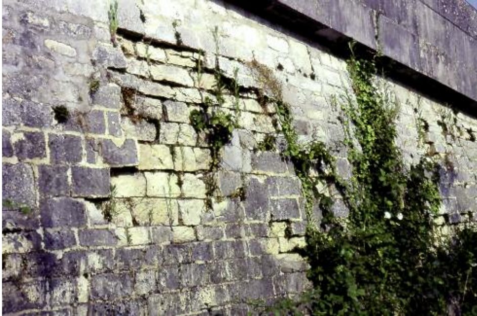
Photo n° 5 : désorganisation des joints et de la pierre (crédit photo J.L. Michotey)
