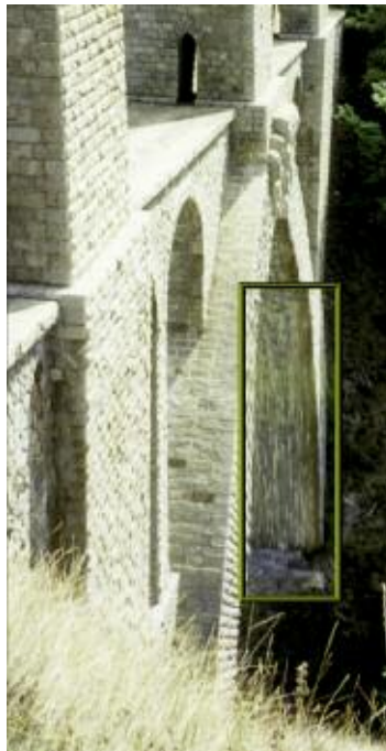
Photo n° 48 : traces de calcite à l'intradors de l'arc brisé du viaduc de Fontpédrouse (crédit photo D. Poineau)
