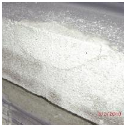
Photo n° 21 : refouillement en sifflet inadapté pour une réparation locale (crédit photo D. Poineau)
