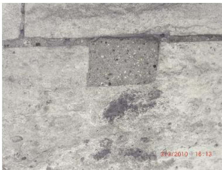
Photo n°18 : réparation locale ancienne avec un mortier à base de ciment (crédit photo D. Poineau)
