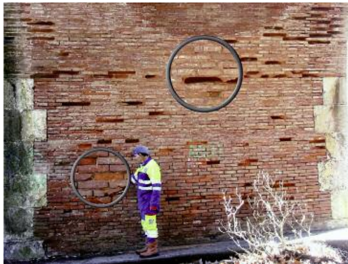
Photo n° 26 : dégradations très localisées de briques (crédit photo Cofex Littoral)
