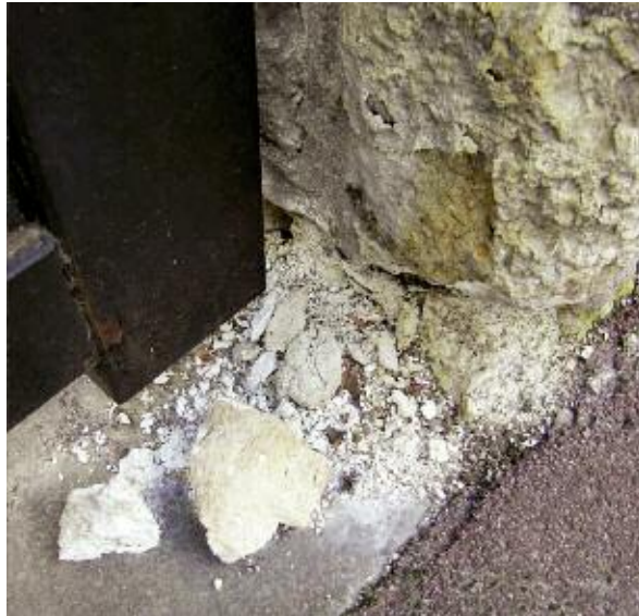
Photo n° 53 : désordres dus à des remontées d'humidité et de sels et survenus juste après une période de gel (crédit photo D. Poineau)
