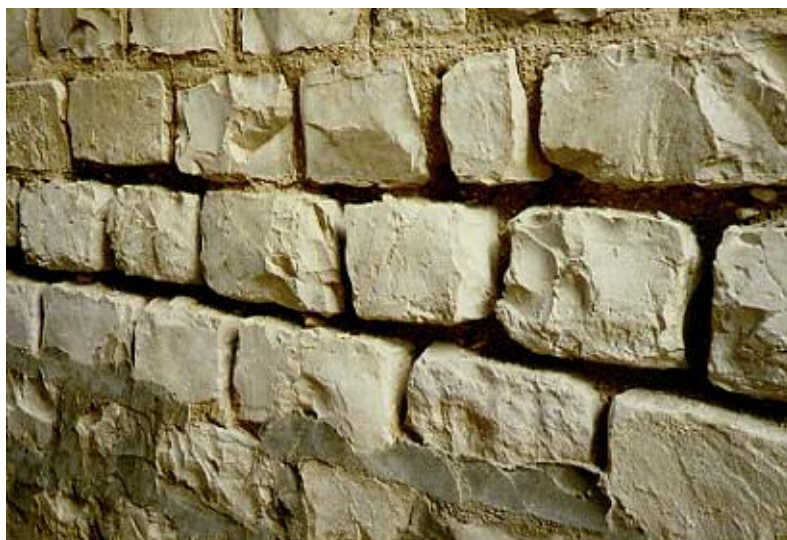
Photo n° 3 : désorganisation des joints et rejointoiment bricolé (crédit photo D. Poineau)
