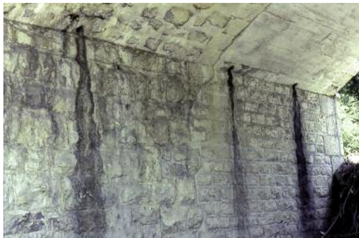
Photo n° 47 : coulures dues à l'absence de débord du tube des gargouilles (crédit photo Michotey)
