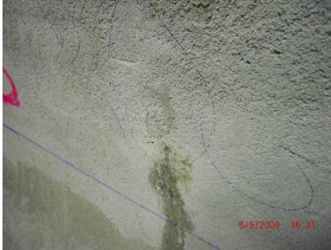
Photo n° 43 : fuite après injections de la maçonnerie et réalisation d'un enduit d'étanchéité (crédit photo D. Poineau)
