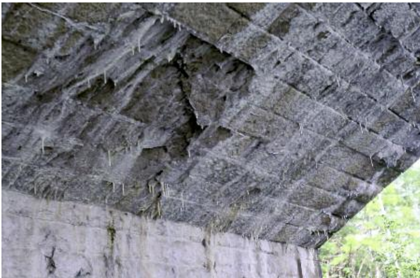
Photo n° 6 : désorganisation des joints, de la pierre et coulures de calcite (crédit photo J.L. Michotey)
