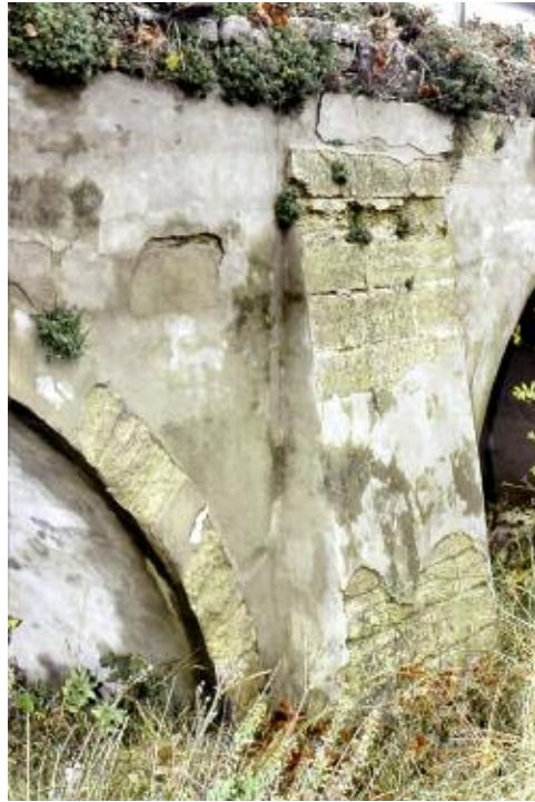
Photo n° 54 : effets néfastes de l'application d'un enduit sur un pont en maçonnerie (crédit photo Michotey)
