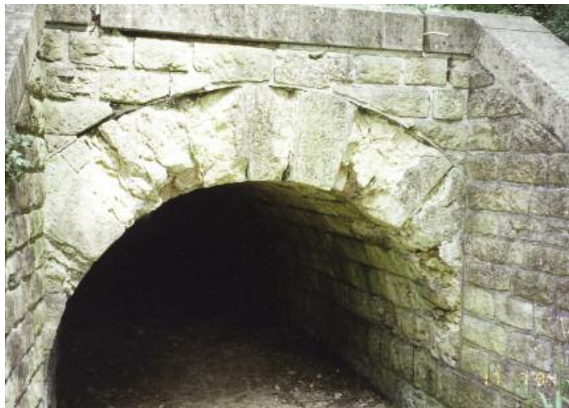
Photo n° 17 : dégradations plus ou moins superficielles des pierres du bandeau d'un ponceau (crédit photo D. Poineau)
