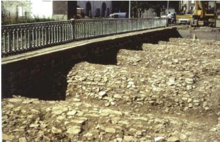
Photo n° 34 : extrados de voûtes après décaissement dont l'état nécessite un rejointoiement, la mise en place d'une couche de forme en BA et d'une étanchéité (crédit photo LRPC)
