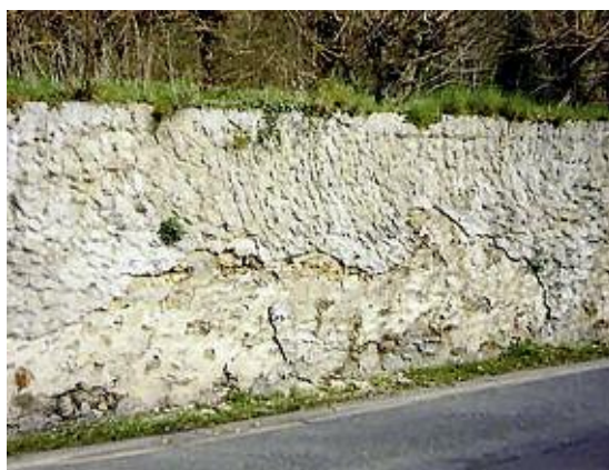
Photo n° 29 : désordres dus à la réalisation d'un enduit sur un mur de soutènement alors que la maçonnerie est exposée à l'eau sur ses autres faces (crédit photo D. Poinéau)
