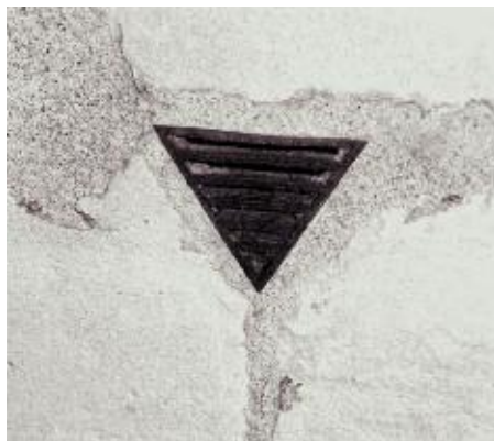
Photo n° 57 : vue de la grille d'un drain atmosphérique (crédit photo D. Poineau)
