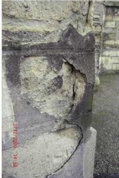
Photo n° 8 : conséquences d'un rejointoiment bâclé et avec un mortier inadapté (crédit photo D. Poineau)
