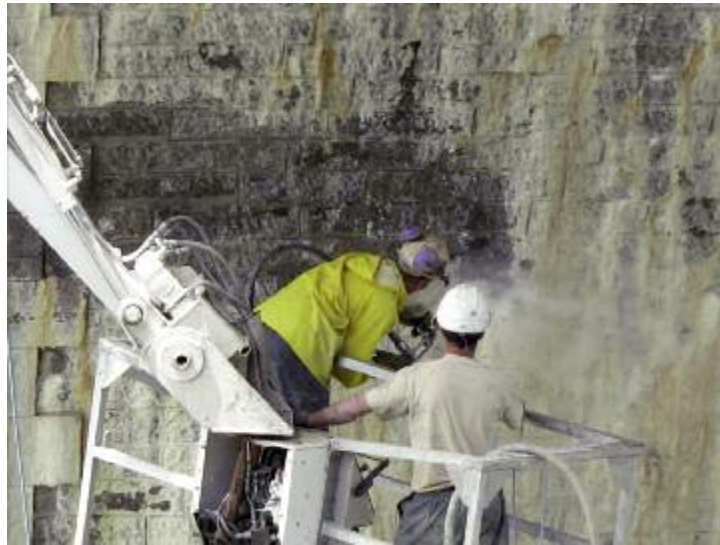
Photo n° 64 : décapage de coulure à THP (2500 bars) au pont des Abarines (crédit photo Cofex Littoral)
