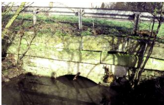
Photo n° 59 : désorganisation de la maçonnerie par des arbustes (crédit photo CDDA 78)
