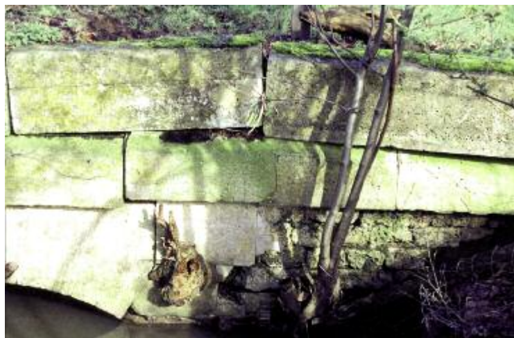
Photo n° 17 : incidences destructrices de la végétation fidèle alliée de l'eau (crédit photo CDOA 78)
