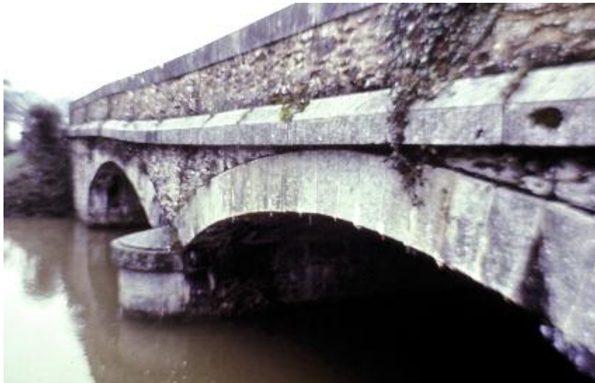
Photo n° 4 : déformation liée à un affouillement sous la fondation de la pile mettant en danger le pont de Régereau sur le Vicoïn (crédit photo J-P Levillain)
