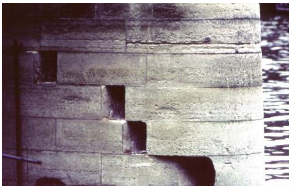
Photo n° 49 : résultat du choc d'un convoi poussé sur une pile de l'ancienne Passerelle des Arts (crédit photo D. Poineau)
