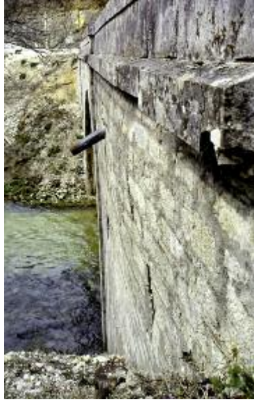
Photo n° 5 : déformation du mur en retour d'un pont en maçonnerie (crédit photo J. M. Michotey)
