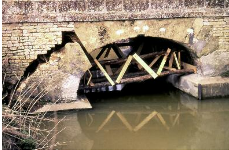
Photo n° 40 : rupture due à l'affouillement d'une culée (crédit photo LRPC)
