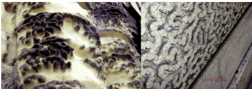
Photo n° 24 : à gauche alvéolisation pathologique de la pierre calcaire des remparts d'Avignon à droite vermiculures sculptées d'un bandeau en pierres de taille d'un immeuble parisien (crédit photo D. Poineau)
