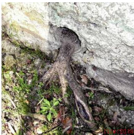
Photo n° 18 : racine dans une des barbacanes d'un mur de soutènement (crédit photo D. Poineau)
