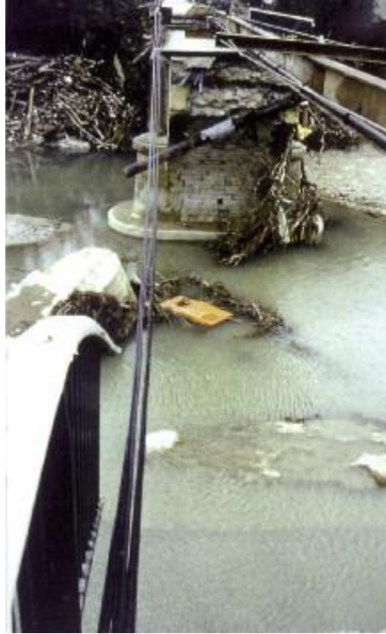
Photo n° 21 : effondrement d'un pont lors des crues du Sud-est en 1992 (crédit photo DDE 84)
