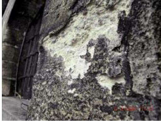
Photo n° 27: desquamation de pierres calcaires de l'église de Villejuif (crédit photo D. Poineau)
