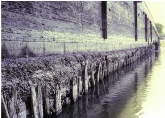
Photo n°43 : dégradation par abrasion d'une pièce de bois de fondation (crédit photo J. P. Levillain)
