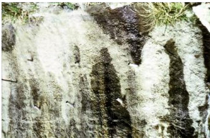
Photo n° 63 : coulures d'eau et de calcite (crédit photo CDDA Corse)
