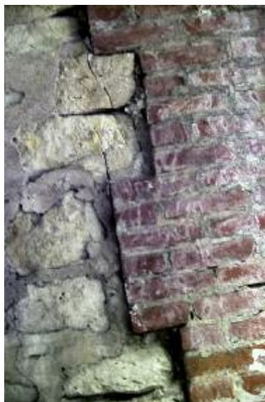
Photo n° 6 : fissure des moellons dans une voûte composite associant la pierre et la brique (crédit photo J. M. Michotey)
