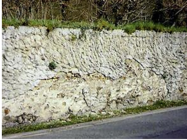
Photo n° 46 : désorganisation de l'enduit ciment et du mur de soutènement en maçonnerie (crédit photo D. Poineau)
