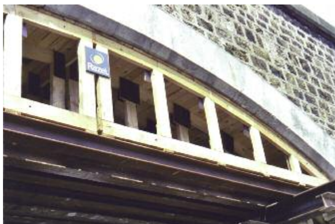
Photo n° 51 : soutènement pendant les travaux de confortement d'un pont à la Poterne des Peupliers (crédit photo D. Poinéau)
