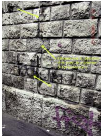
Photo n° 31 : fissure due à l'absence d'un joint de fractionnement (crédit photo D. Poineau)
