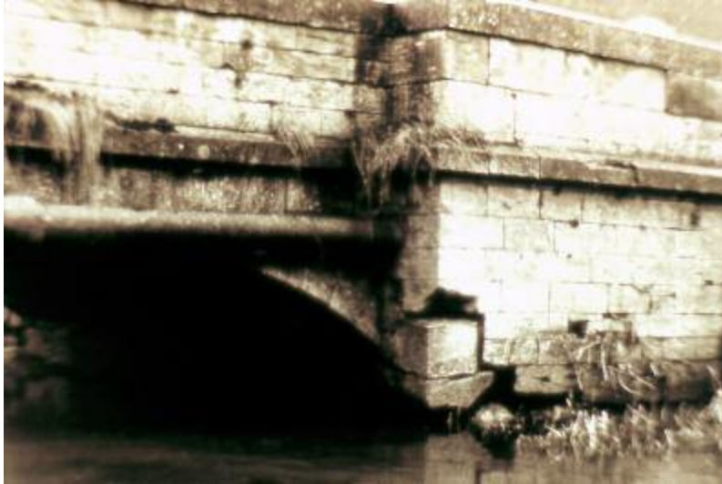
Photo n° 19: désorganisation des murs en retour d'une culée (crédit photo LRPC)
