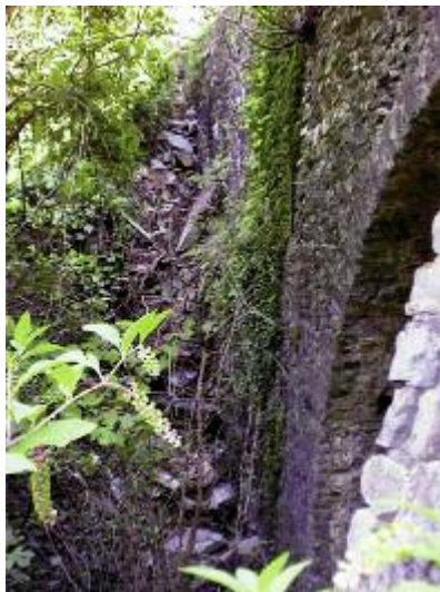
Photo n° 58 : pont en maçonnerie envahi par la végétation (crédit photo Cofex-Littoral)
