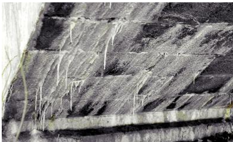
Photo n° 33 : concrétions de calcite sous l'intrados d'une voûte (crédit photo J. M. Michotey)
