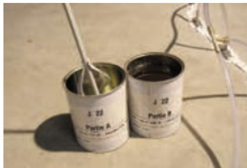
Photo n° 12 : fin du malaxage de la résine et du durcisseur (crédit photo Freyssinet)
