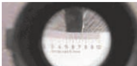
Photo n° 23 : mesure de l'ouverture apparente d'une fissure au moyen d'un compte-fils (crédit photo Freyssinet)
