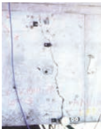
Photo n° 2 : fissure due à une insuffisance de résistance à la flexion d'une poutre en béton précontraint (crédit photo LRPC d'Aix-en-Provence)
