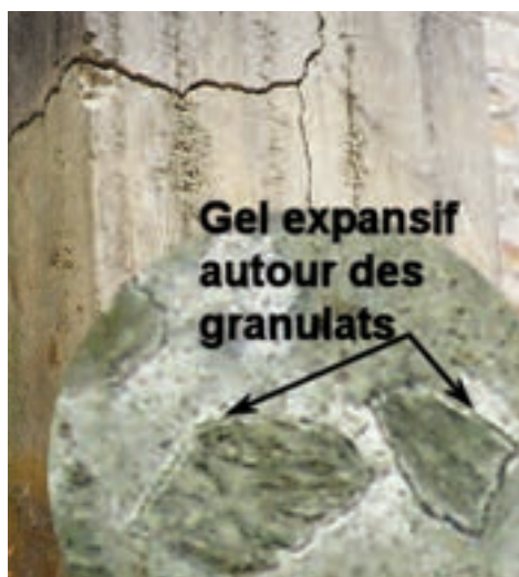
Photo n° 26 : fissures dues à une réaction alcali-réaction (crédit photo Poineau)
