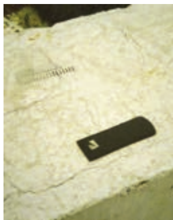
Photo n° 1 : fissures caractéristiques des cassures dites du béton frais (crédit photo Poineau)
