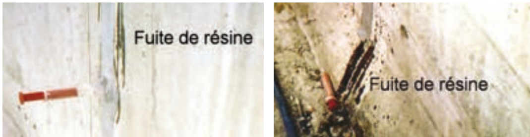
Photo n° 40 : fuites de résine d'injection (crédit photo Poineau)
