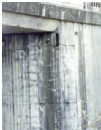
Photo n° 3 : fissuration due à une alcali-réaction du piédroit d'une culée (crédit photo Poineau)
