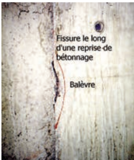
Photo n° 27 : fissure masquée localement par une balèvre (crédit photo Poineau)
