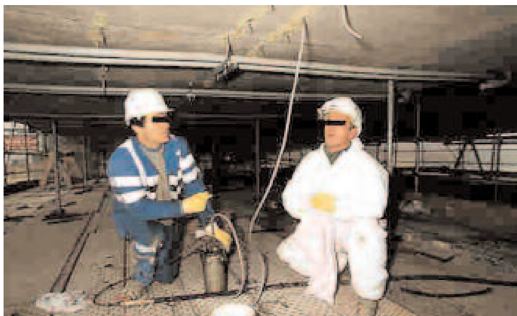
Photo n° 4 : injection de fissures au pont de Châlons-en-Champagne (crédit photo Sétra)
