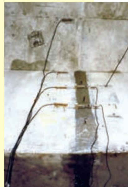
Photo n° 35 : implantation de jauges et de capteur pour contrôler une fissure active (crédit photo LRPC)
