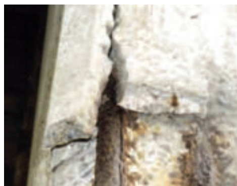
Photo n° 25 : fissure engendrée par la corrosion d'une armature de BA (crédit photo Poineau)
